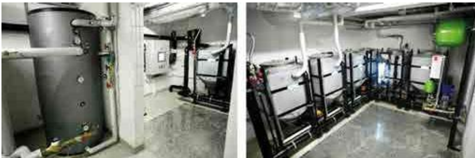
Figura 8. Instalación de recuperación y tratamiento de aguas grises Pontos AquaCycle combinada con el módulo de recuperación de energía Pontos HeatCycle en la residencia de estudiantes OIKOS en Friburgo, Alemania. Fuente: Pontos GmbH/Hansgrohe AG.
