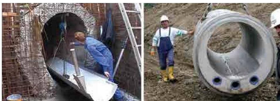
Figura 13. Ejecución de las obras de instalación de intercambiadores: instalado en un colector ovoide existente, e integrado en el hormigón un conducto de sección circular en una nueva construcción.
