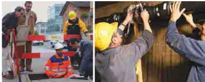
Figura 23. Renovación de un colector cerca de un edificio una instalación de intercambio de energía con las aguas residuales. Fuente: ENERES/KASAG.
