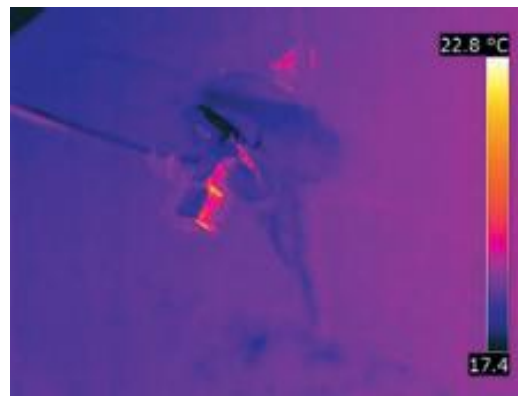
Imagen 14. Fugas en la instalación. Lo que no se detecta a simple vista se puede detectar con la cámara infrarroja: se aprecian restos de humedad, comprobándose posteriormente al retirar el embellecedor cómo fuga la rosca de la llave de cierre.
