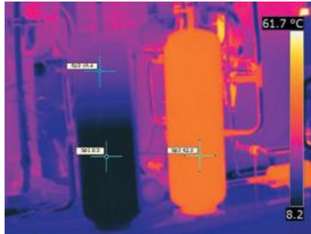
Imagen 24. Aplicación a líquidos refrigerantes: localización de nivel y temperatura. Fuente: eBuilding.
