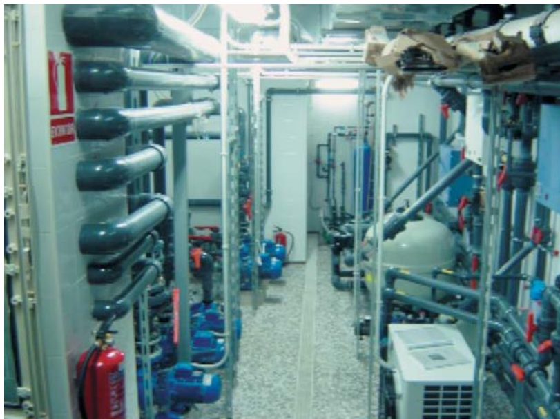
Fotografía 8. Tratamiento de aguas.
