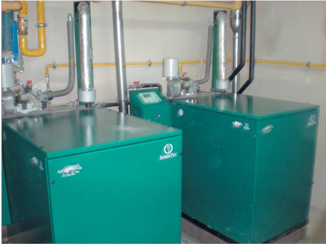
Foto 3. Detalle de los equipos.
