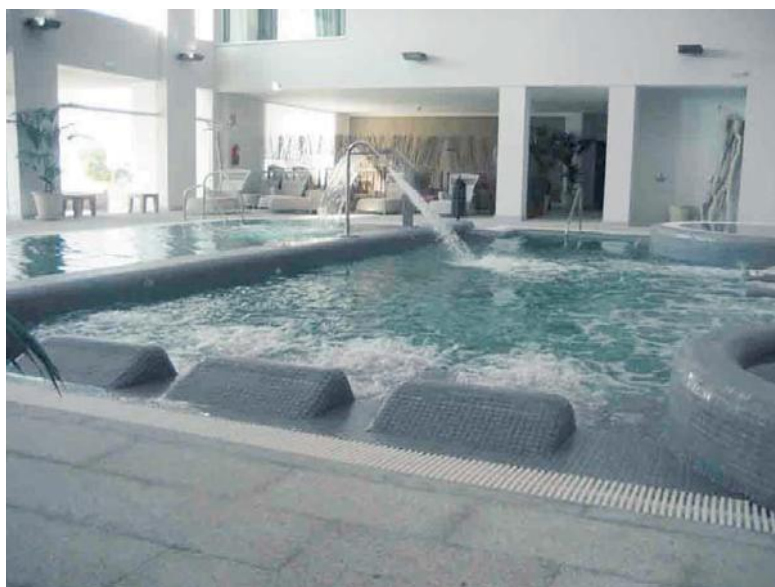
Fotografía 5. Centro de hidroterapia. Fuente: Hidroingenia.
