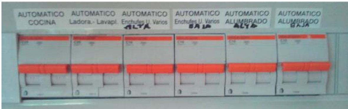
Figura 13. Pequeños interruptores automáticos (PIAs).
