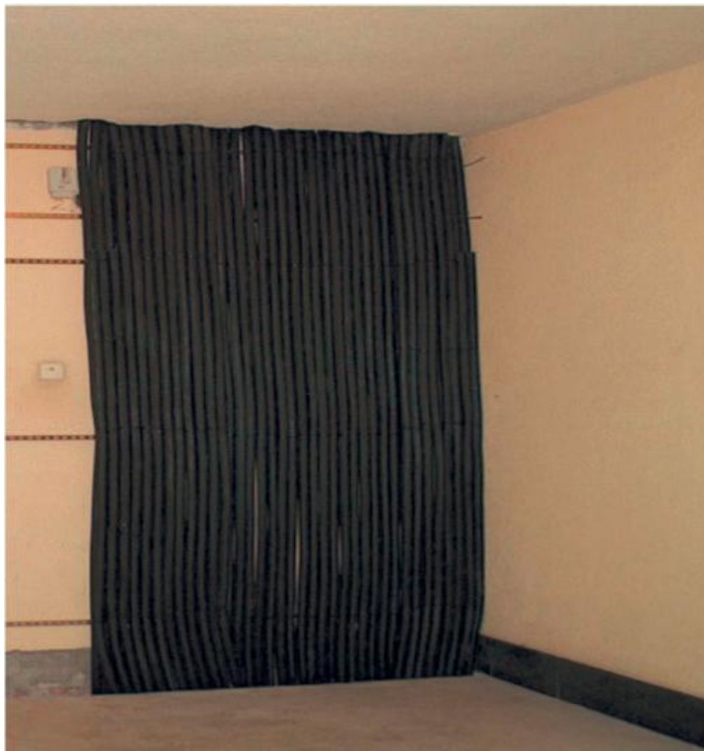
Figura 9. Canalizaciones de derivaciones individuales.
