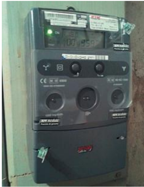
Figura 7. Contador electrónico trifásico.
