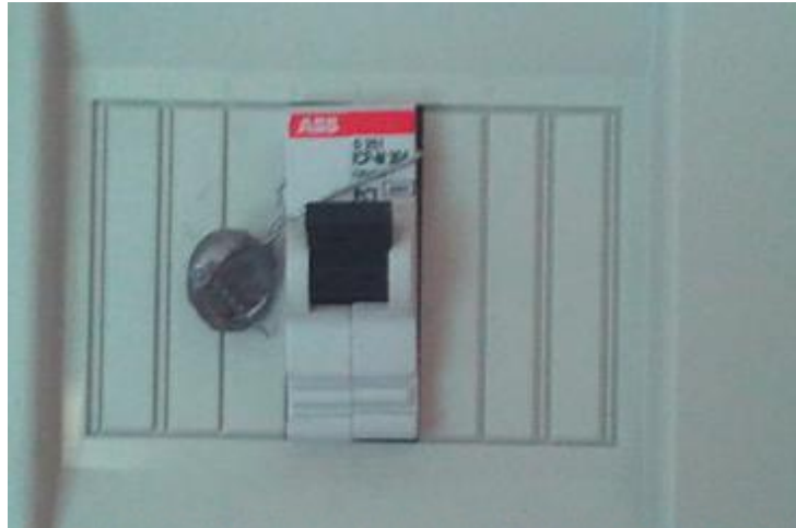
Figura 10. Interruptor de Control de Potencia (ICP) de 30 A.
