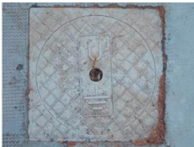
Figura 18. Toma de tierra.
