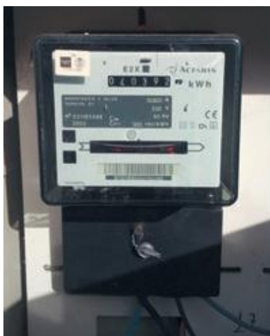
Figura 5. Contador individual en vivienda unifamiliar.
