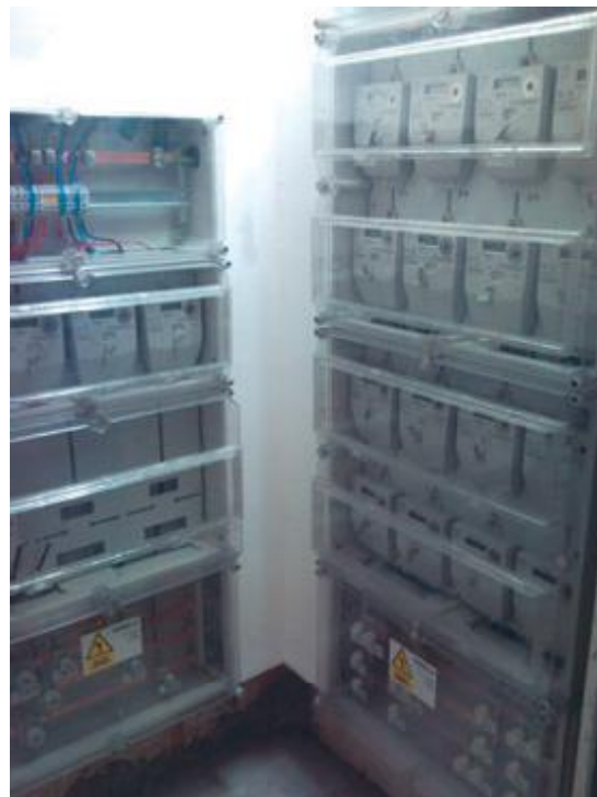
Figura 8. Detalle de centralización de contadores.
