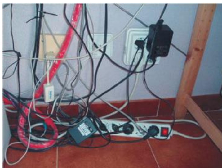
Figura 20. Incorrectas conexiones en enchufes múltiples.
