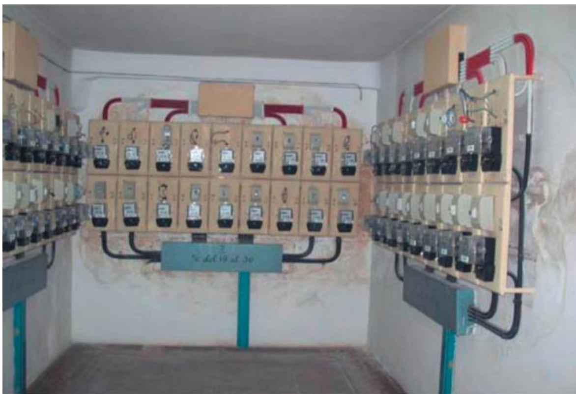
Figura 4. Centralización de contadores.
