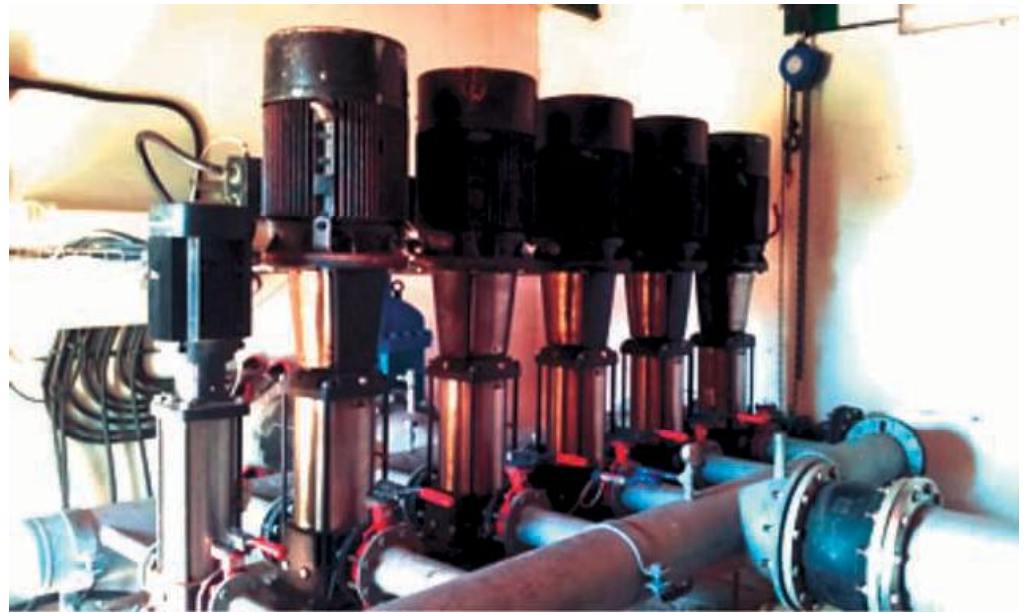
Foto 1. Sistema de impulsión de un campo de golf. Fuente. Audit Irrigation
