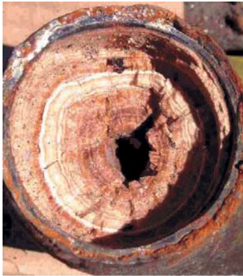
TUBERÍA COLMATADA CON SEDIMENTOS CALCÁREOS
