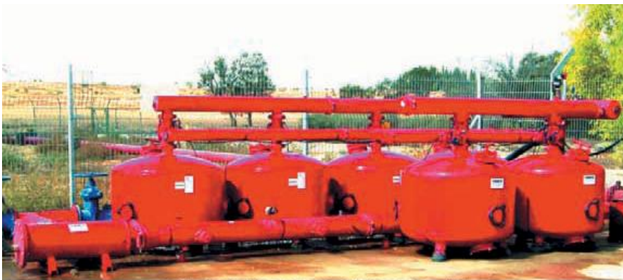
CABEZAL DE FILTRACIÓN DE ARENA
