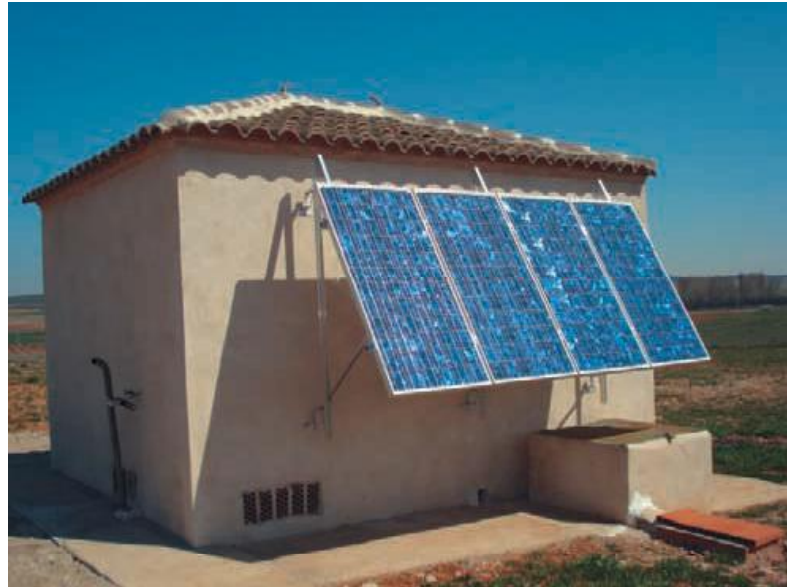
Foto 3. Ejemplo fotovoltaica instalada sobre una pared. Fuente: Abaco Ambiental.
