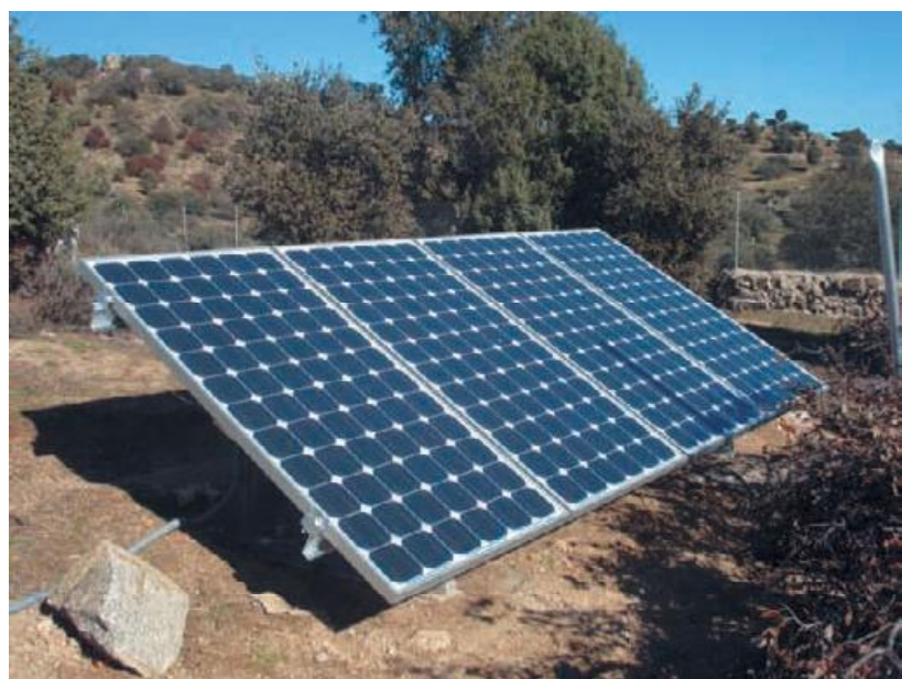
Foto 4. Ejemplo fotovoltaica instalada sobre suelo. Fuente: Abaco Ambiental.
