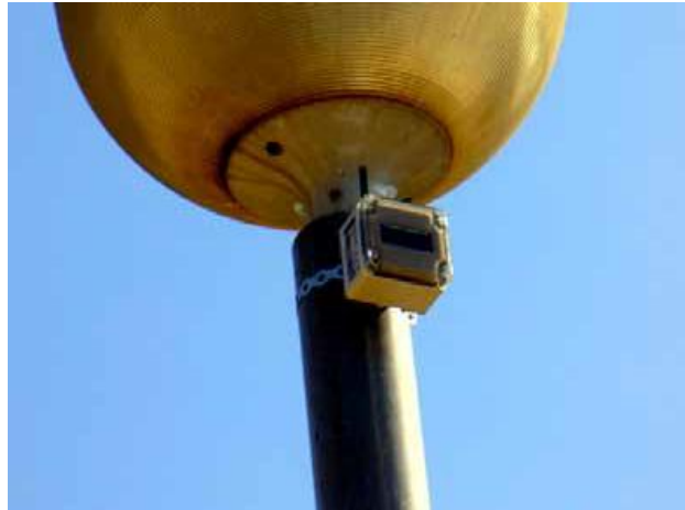
Foto 3. Equipo Repetidor alimentado por Energía solar. Fuente: Samcla
