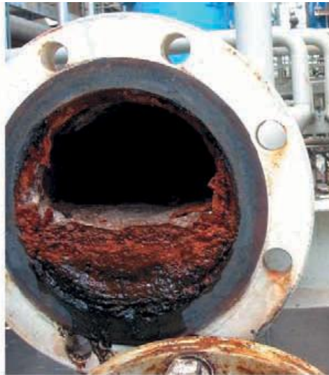
TUBERÍA COLMATADA CON BIOCAPA
