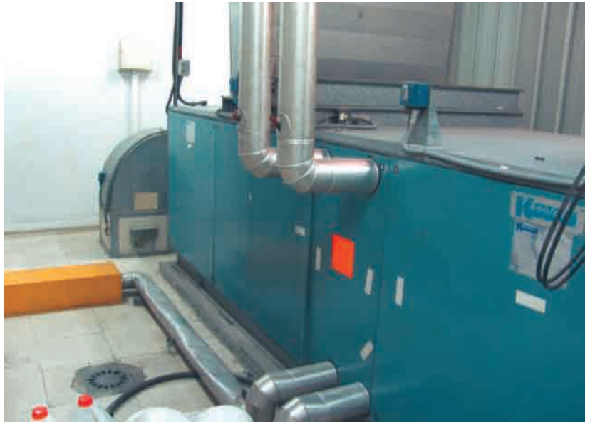
Foto 3.4. Sistema de renovación y control de la calidad del aire. Fuente: Geoter.
