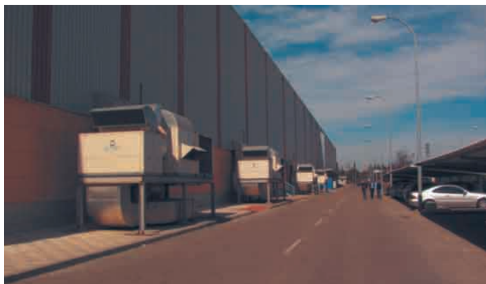
Foto 4.3. Zonas de renovación y climatización de naves en un gran centro logístico de la Comunidad de Madrid. Fuente: Geoter.
