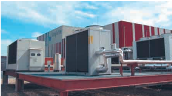
Foto 3.1. Zona de instalaciones térmicas en cubierta. Fuente: Geoter.
