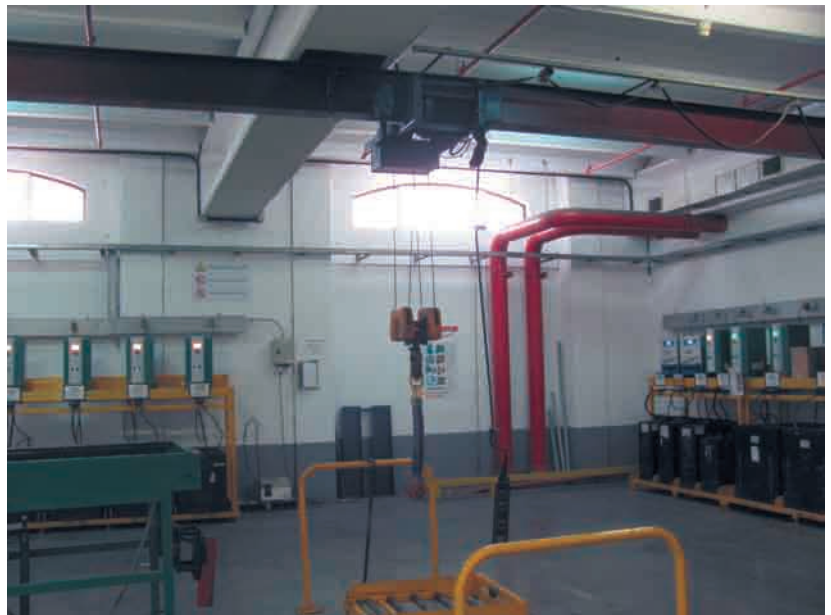
Foto A3.3. Iluminación en centro de control de centro logístico. Fuente: Geoter.
