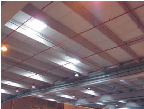
Foto A3.1. Optimización de la utilización de la luz solar en un gran centro logístico. Fuente: Geoter.
