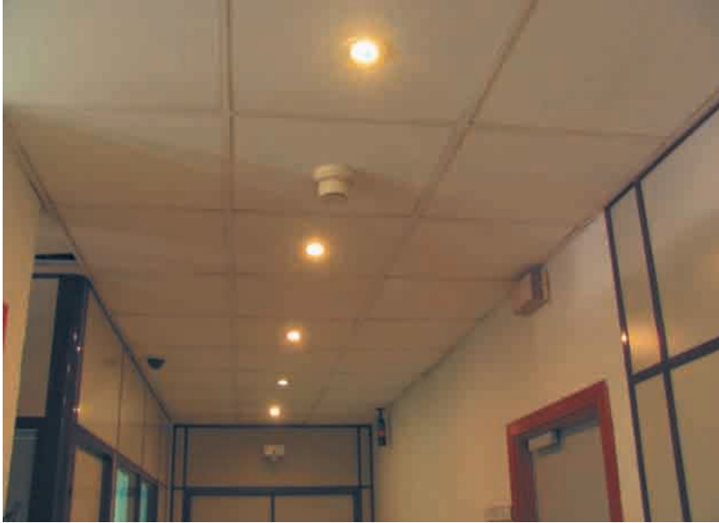
Foto A3.2. Iluminación en zona de paso de oficinas en centro logístico. Fuente: Geoter.
