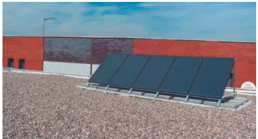
Foto 3.2. Instalación de captadores solares térmicos para cumplimiento del CTE. Fuente: Geoter.
