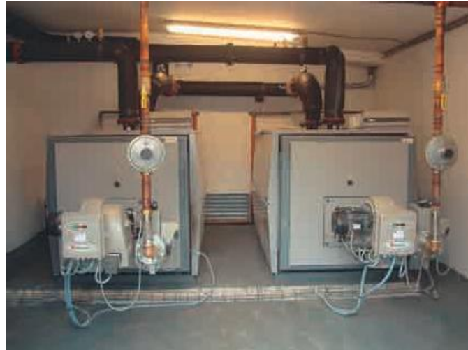
Figura 1. Grupo de calderas para altas potencias (Fuente: Ferroli)
