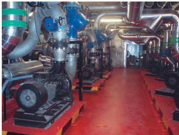
Figura 8. Grupos frigoríficos instalados en el La Vaguada.
