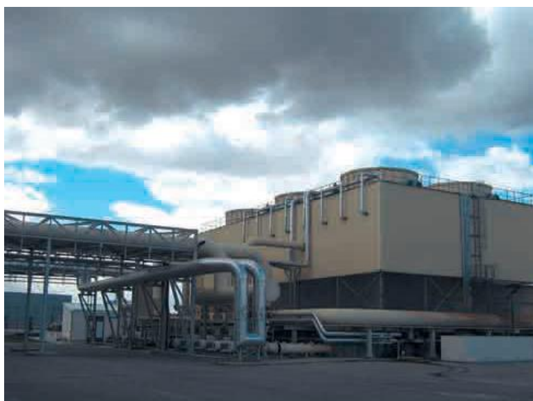
Figura 9. Equipos de trigeneración en el Aeropuerto Madrid Barajas (Fuente: AENA).
