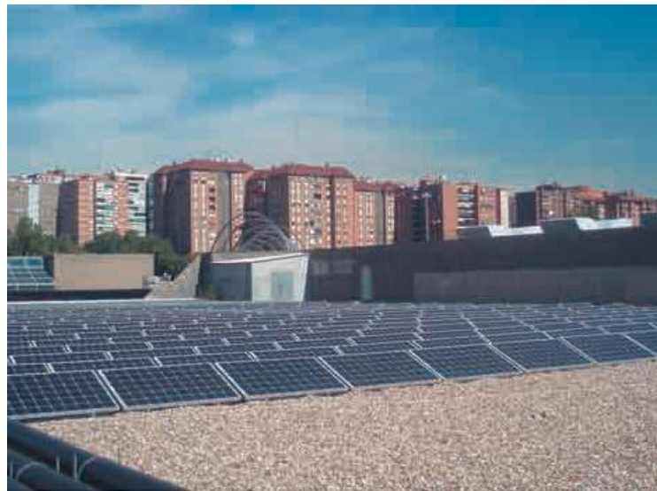
Figura 12. Instalación fotovoltaica en el supermercado La Vaguada.
