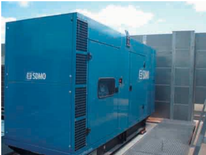
Figura 10. Ejemplo de grupo electrógeno.
