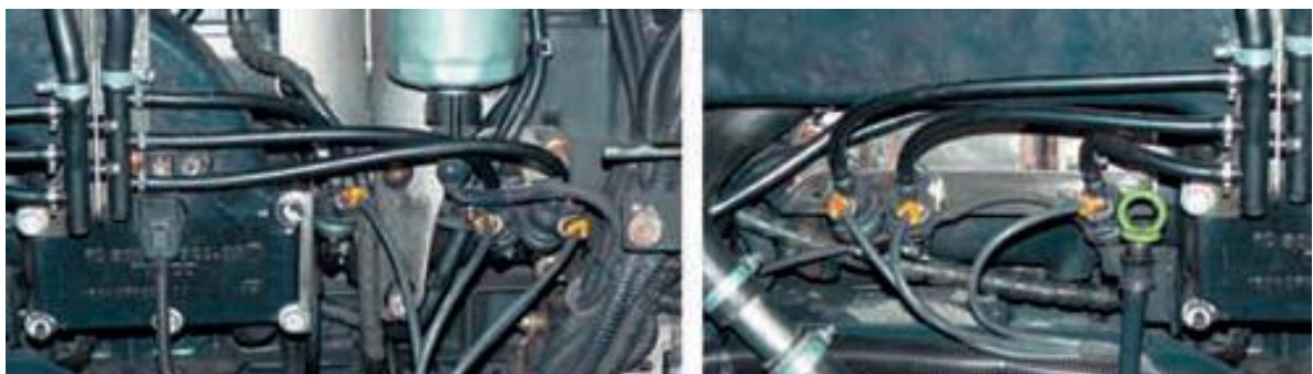
Figura 3.7. Inyectores de gas natural en la culata del motor diésel. Fuente: EMT, 2013.
