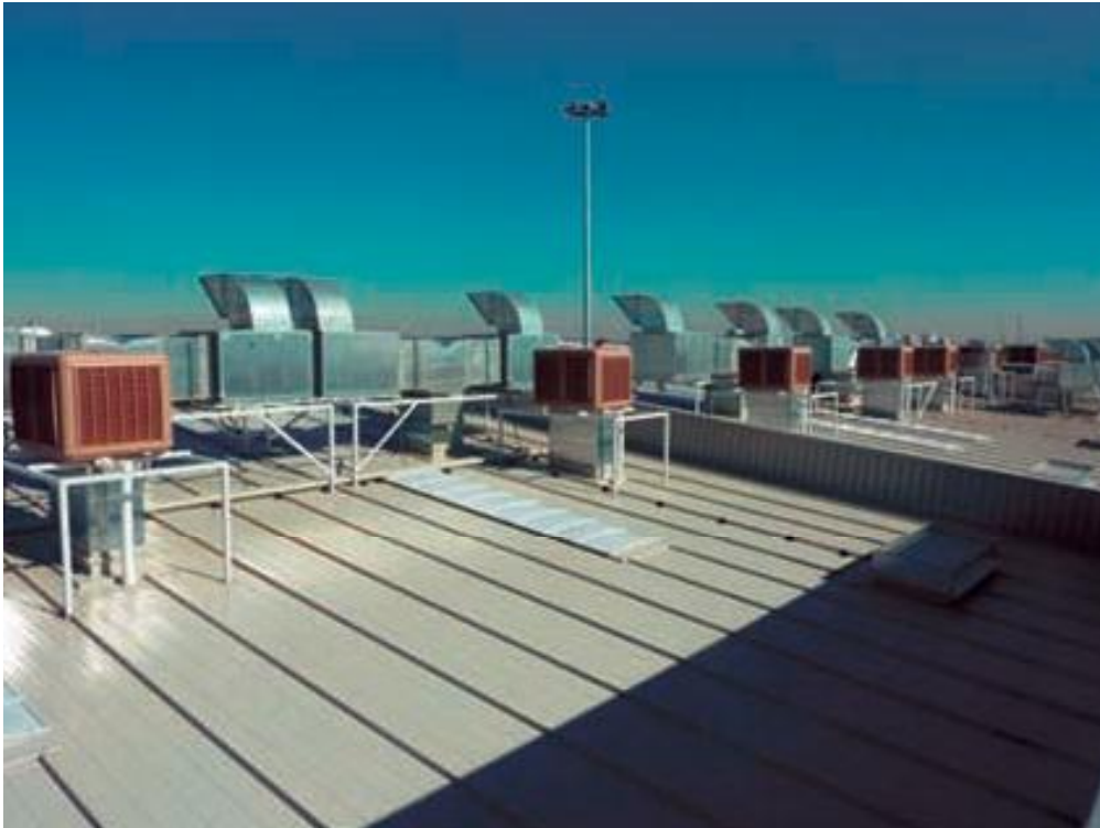
Figura 3.20. Equipos de climatización de alta eficiencia instalados en cubierta. Fuente: EMT, 2013.
