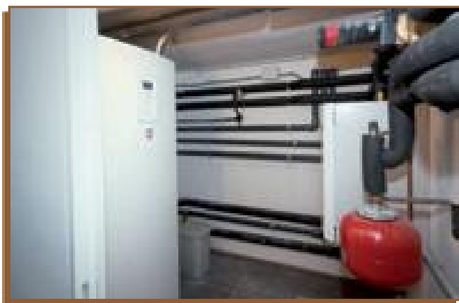
Instalación con calefacción, frío pasivo y ACS
