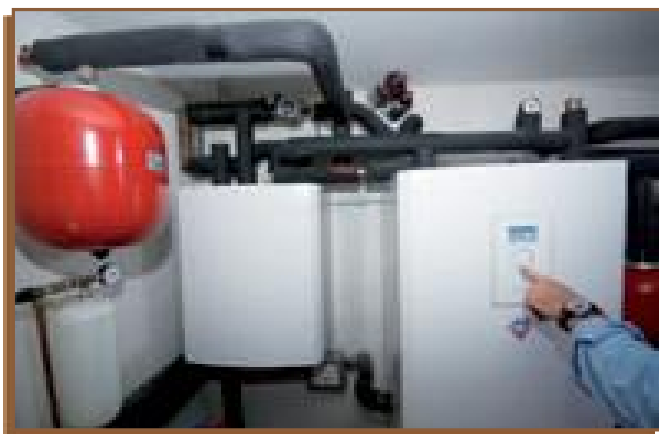
Instalación con calefacción, frío activo y ACS
