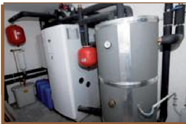
Instalación con calefacción, frío activo, ACS y piscina
