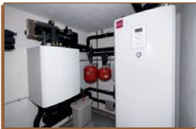
Instalación con calefacción, frío activo y ACS
