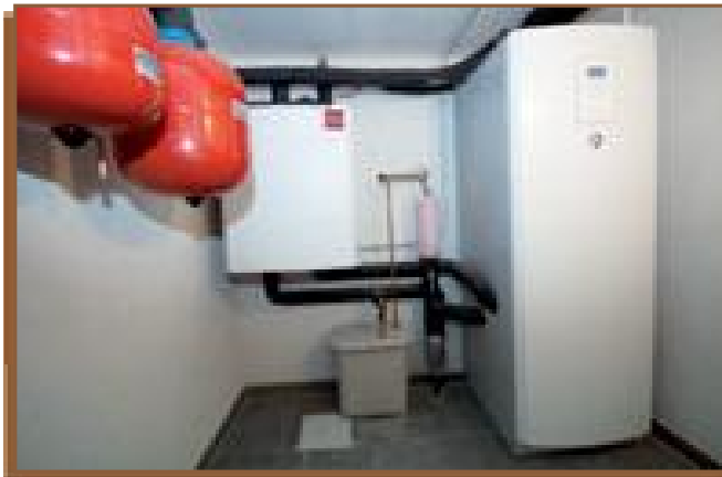
Instalación con calefacción, frío pasivo y ACS
