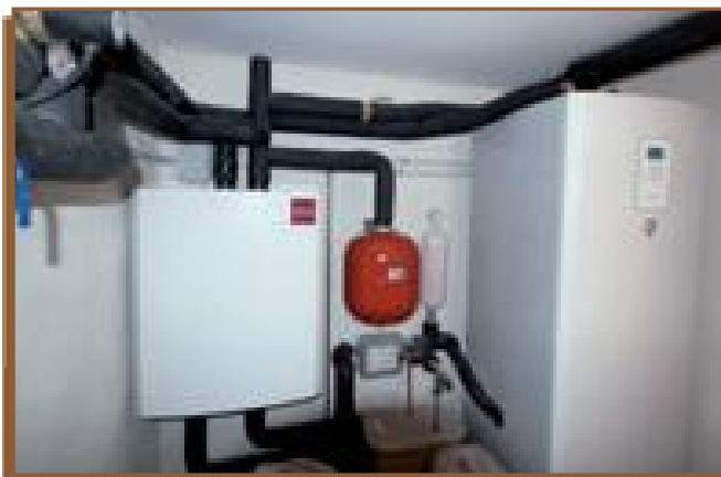
Instalación con calefacción, frío pasivo y ACS
