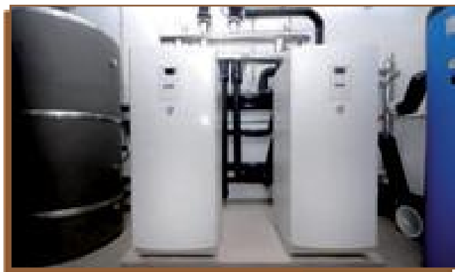
Instalación de climatización geotérmica en el edificio de Misioneros de África situado en Madrid
