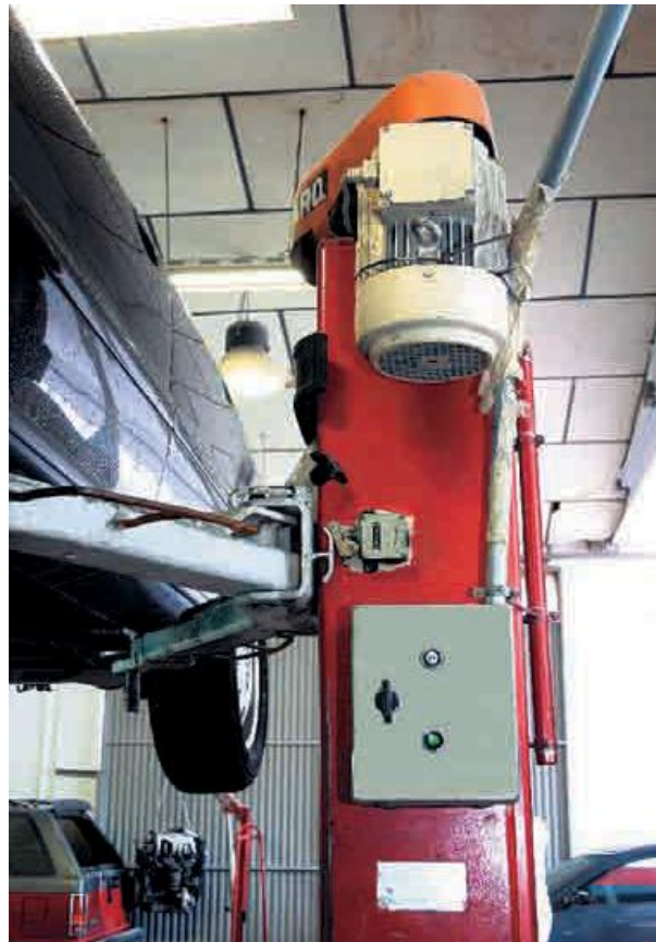
Foto 1.1. Motor eléctrico de elevador.
