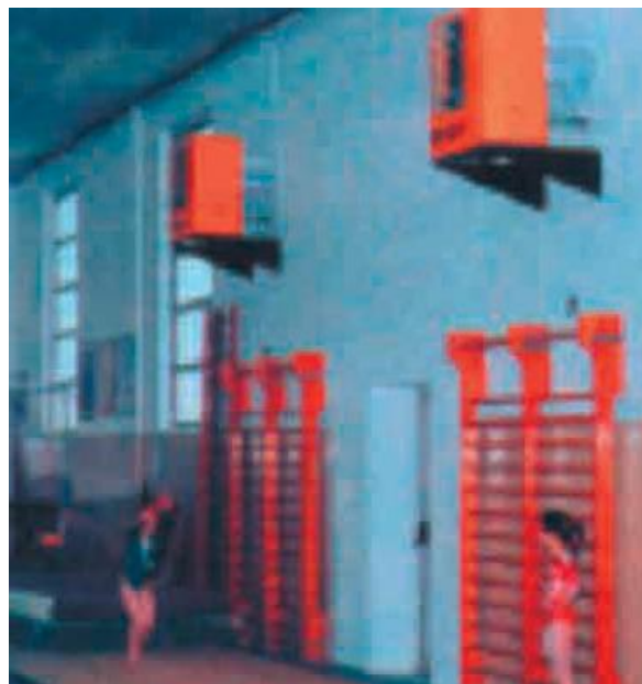
Foto 4.11. Calefacción de talleres. Aerotermos a gas natural.
