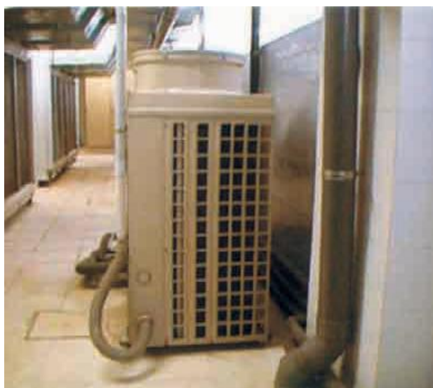
Foto 1.5. Equipo exterior de bomba de calor.
