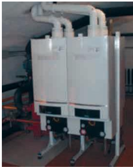
Foto 4.12. Calderas modulares a gas natural. Calefacción y ACS.
