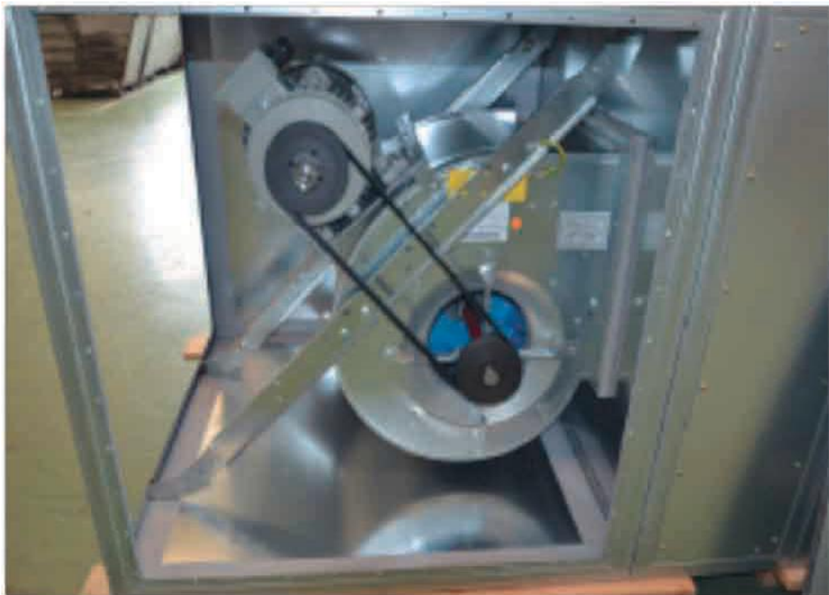
Foto 2.1. Ventilador transmisión de poleas.
