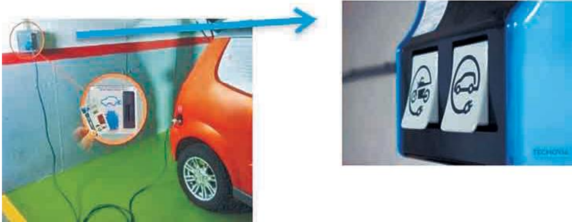
Figura 6.2. Recarga del coche eléctrico.
