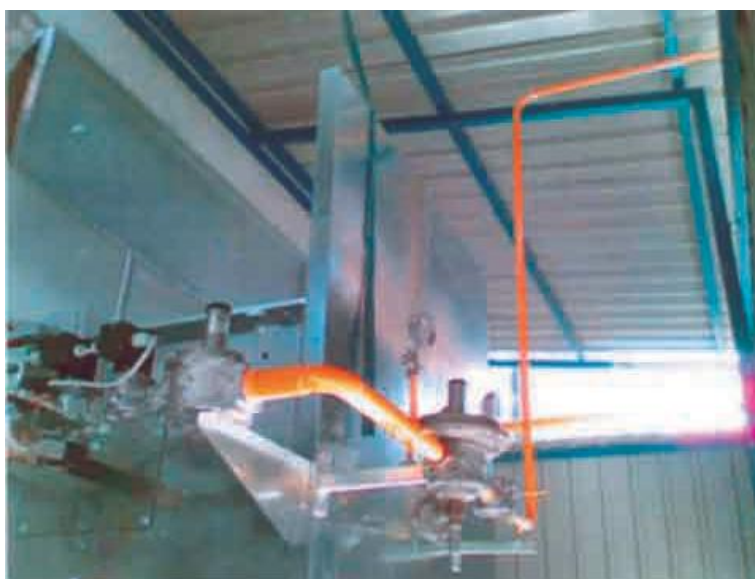
Foto 4.8. Quemador en vena de aire. Conjunto exterior (II).
