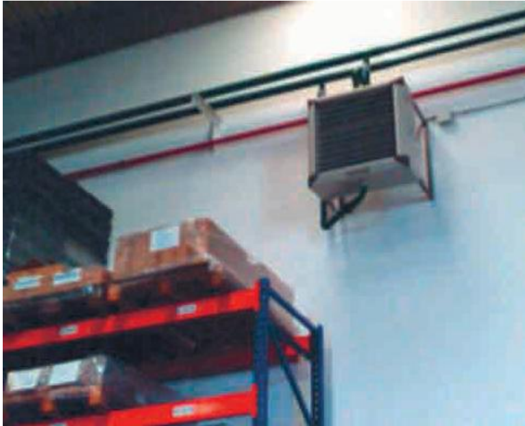
Foto 4.10. Calefacción de talleres. Aerotermos de agua caliente.
