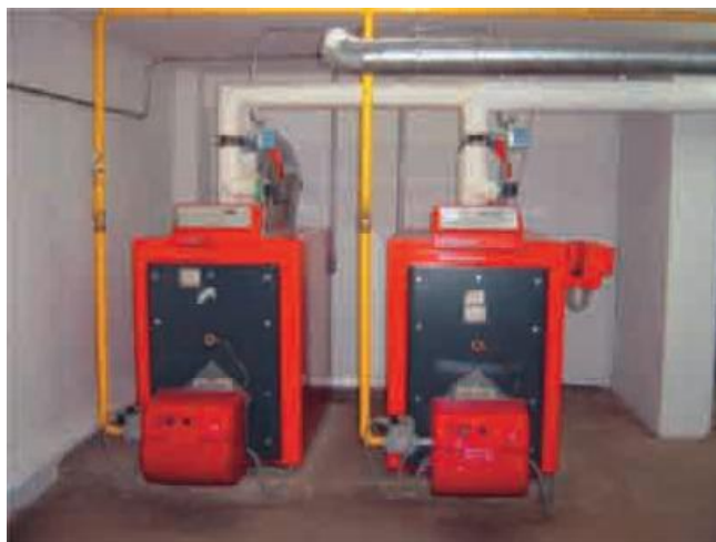
Foto 4.4. Calderas de pie a gas natural. Calefacción y ACS.
