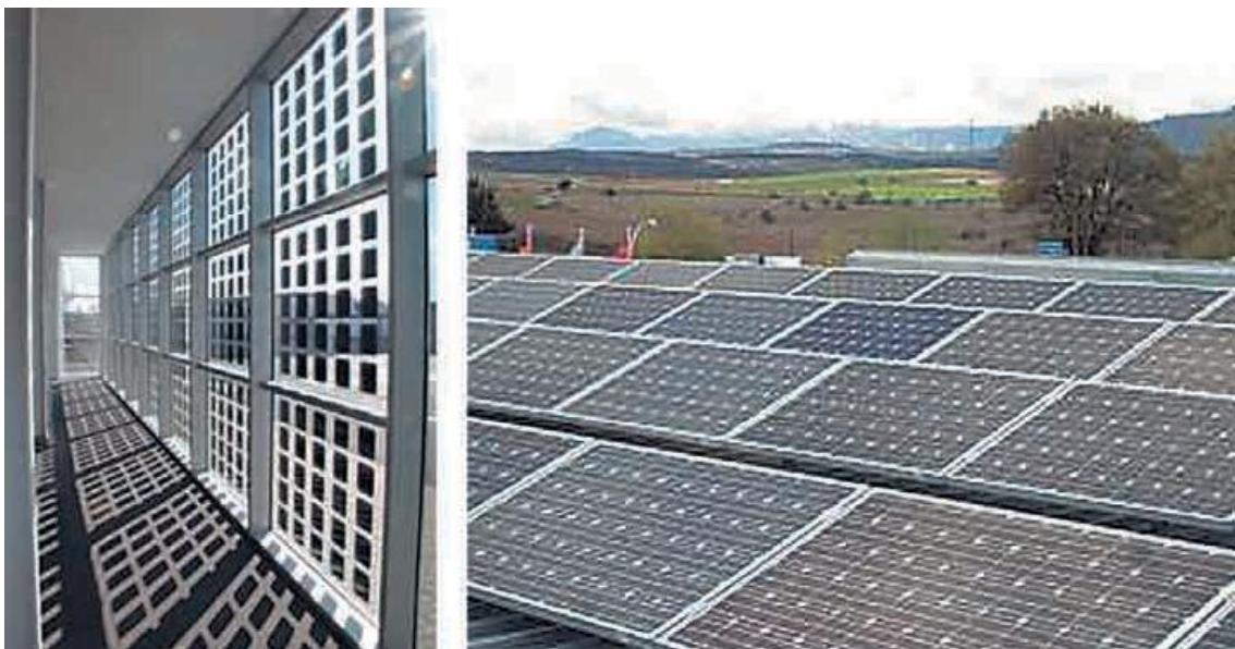
Foto 6.2. Diferentes tipologías de módulos fotovoltaicos en fachada y cubierta.
