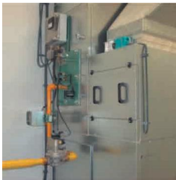
Foto 4.3. Quemador de gas natural en cabina de pintura.
