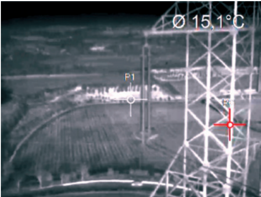
Figura 20.4. Imagen termográfica tomada por un dron de la cadena de aisladores de un apoyo de suspensión.
