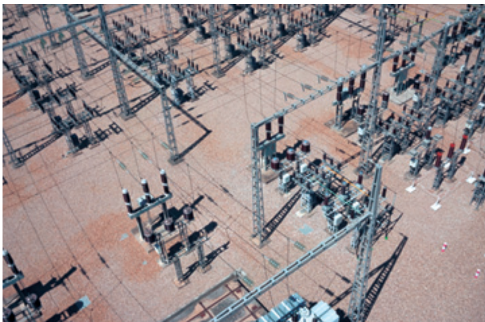
Figura 20.6. Imagen tomada por un dron de las instalaciones de una subestación.
