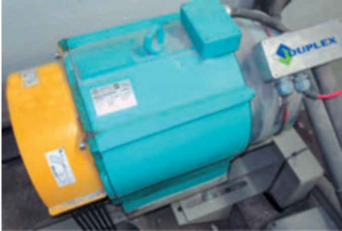
Foto 3. Máquina Gearless. Fuente: Dúplex Elevación.
