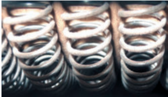
Foto 2. Detalle de la resistencia de frenado. Fuente: Dúplex Elevación.
