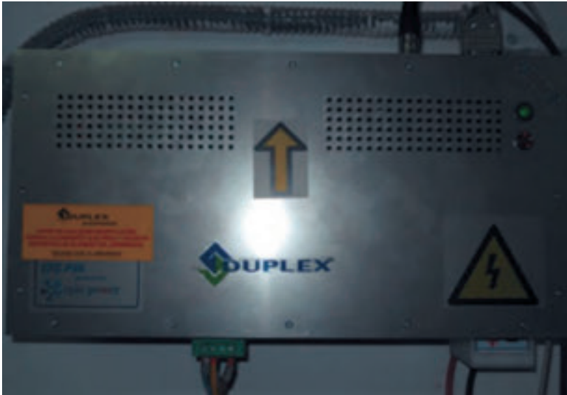
Foto 4. Detalle de la instalación del convertidor bidireccional ERS P3k. Fuente: Dúplex Elevación.
