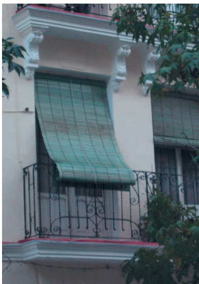
Foto 2.2. Sistemas de control solar tradicional con pérdida de visión y aportes luminosos. Fuente: Propiedad del autor.
