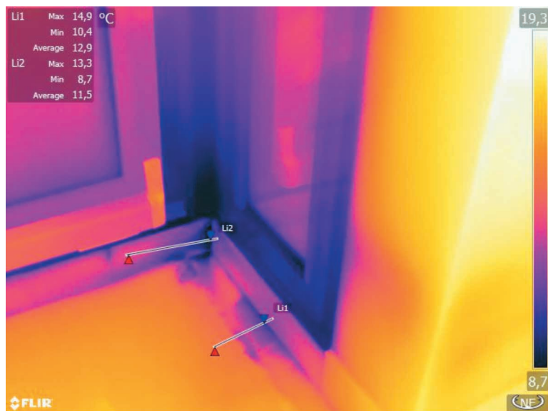
Foto 11.21. Un defecto muy habitual que encontramos es el de no colocar aislamiento bajo los grandes ventanales. Esto es debido al poco espacio que deja la ventana para colocarlo pero que de no hacerlo, deja libre el paso de aire bajo el rodapié.
