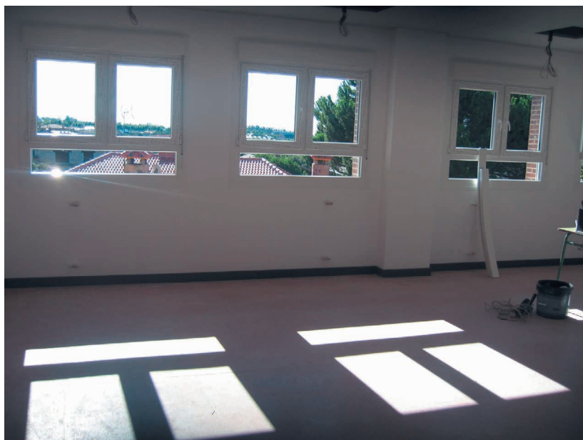
Foto 2.1. Ventanas con acristalamiento de Aislamiento Térmico Reforzado y Control Solar permitiendo visibilidad y grandes aportes de luz. sGG CLIMALIT PLUS con PLANITHERM 4S ( U=1,0 W/m 2 K; g=0,43 ; TL=65\% ). Rehabilitación IES Diego Velázquez (Torrelodones -Madrid). Fuente: sGG CLIMALIT– Saint-Gobain Glass.
