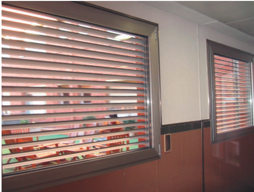
Foto 2.5. Ventanas dotadas de lamas horizontales como medio de protección solar y doble acristalamiento tradicional. La visibilidad y el aporte de luz se ven fuertemente reducidos. Fuente: Propiedad del autor.
