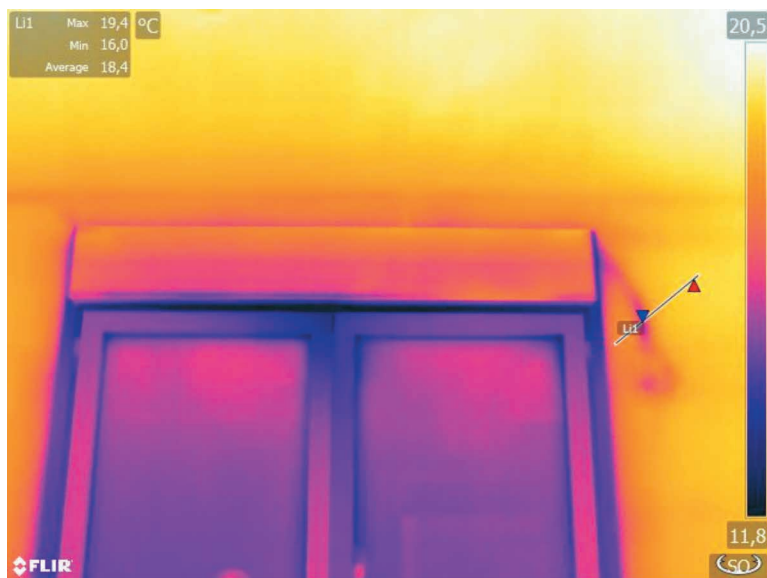
Foto 11.20. En la línea Li1 se aprecia un punto frío debido a la roza por el que discurre el cableado del mecanismo motorizado de la persiana. Si no se ejecuta bien, este mecanismo comunicará el exterior de la vivienda con el interior.
