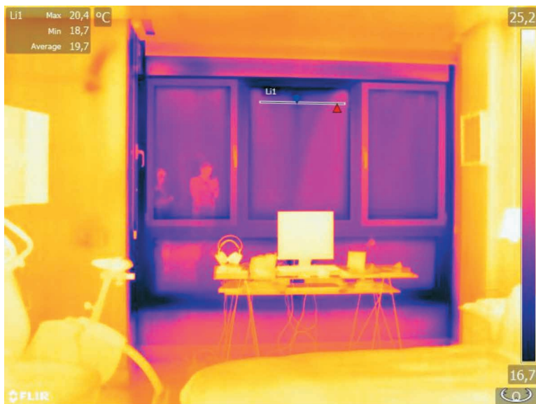
Foto 11.18. Unión del vidrio al marco defectuosa que deja pasar gran cantidad de aire. Se aprecia claramente una huella térmica fría en sentido descendente en el vidrio
