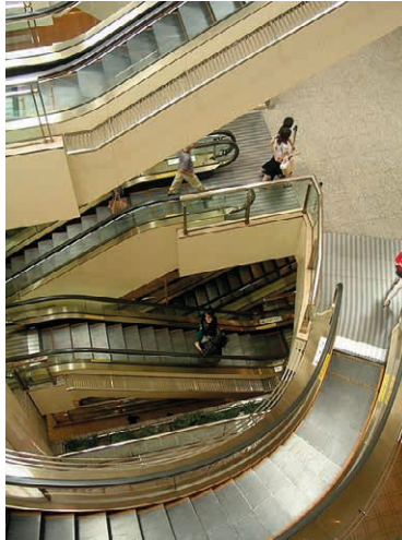
Foto 2.4. Escalera Mecánica Mitsubishi en Jokohama.
