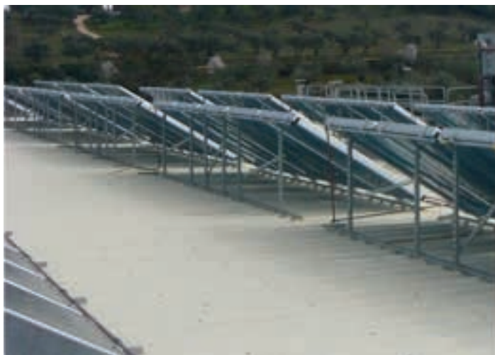
Foto 8.1. Instalación solar térmica aplicada a proceso industrial.
