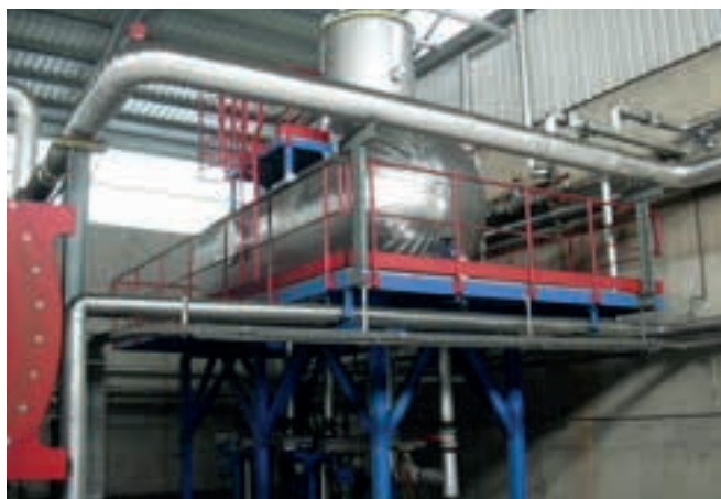
Foto 8.4. Sistema de vapor industrial (180 °C) semi-abierto.
