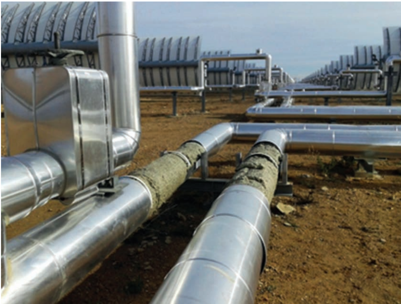
Figura 4.12.2.A. Ejemplo de mantenimiento en planta.
