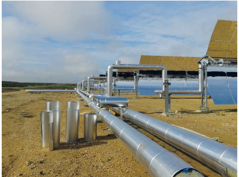
Figura 4.12.1.A. Ejemplo de mantenimiento en planta.
