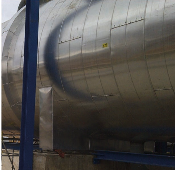
Figura 4.11.6. Ejemplo de ejecución de aislamiento de conservación de calor.
