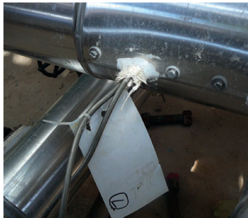
Figura 4.11.11. Ejemplo de salida de cable por el recubrimiento en instalación traceada.
