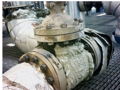
Figura 2.1. Instalación con Aislamiento Deteriorado y Zonas sin Aislar.
