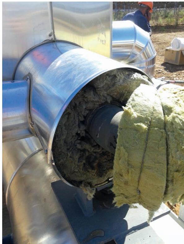
Figura 4.12.1.B. Ejemplo de mantenimiento en planta.
