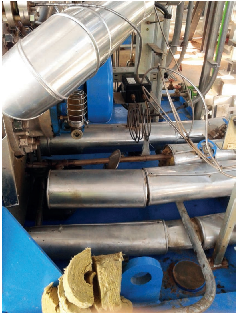
Figura 4.12.2.B. Ejemplo de aislamiento dañado en planta.
