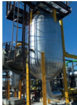
Figura 4.4.3.A. Ejemplo aislamiento en equipo vertical.
