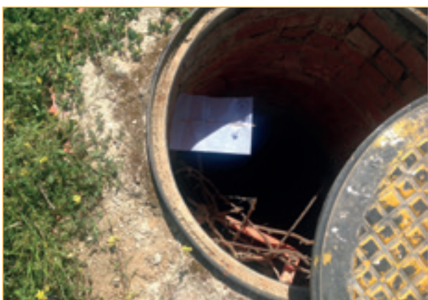
Trampa adhesiva en registro.
