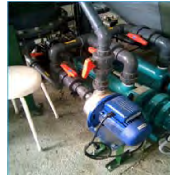
Figura 44. Imagen de las bombas de trasvase de rebose a pH adecuado hacia el lecho fluidizado En color azul la bomba de recirculación de la columna de desorción
