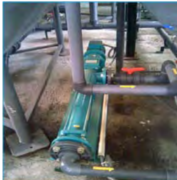
Figura 43. Bomba de alimentación a la columna de desorción
