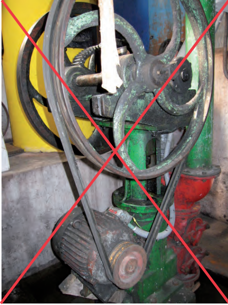
Correa sin protección en bomba de vendimia.
