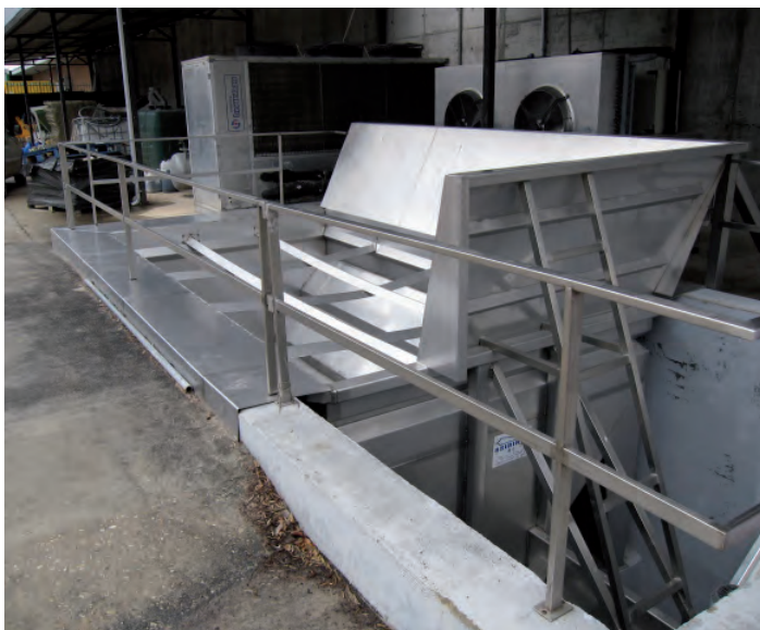
Protecciones en la tolva de recepción. Bodega Tagonius (Tielmes).
