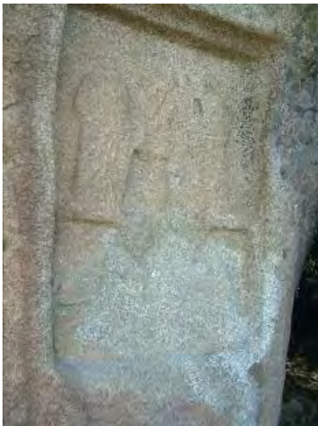
Fig. 14.- Desplacados y disgregación granular.
