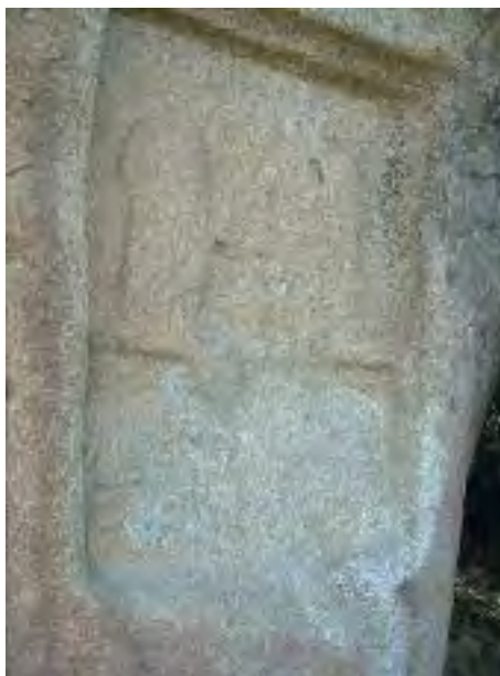
Fig. 4.- Patologías, desplazados y disgregación granular.
