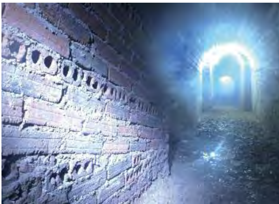
Fig. 7.- Refuerzos de ladrillo en una de las galerías del Refugio del Hospital de Santiago. Datan de época franquista y fueron dispuestas tras las denuncias de los vecinos que advirtieron del peligro inminente de derrumbe. Foto: Santiago David Domínguez-Solera.
