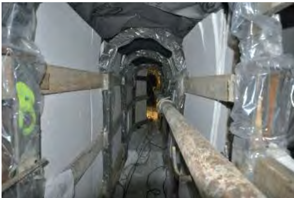
Fig. 5.- Protección de la galería de suministro.
