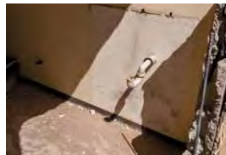
Detalle de instalación hidráulica y sanitaria.
