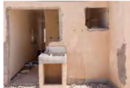
Vanos de ventanas y puertas ya desmanteladas. Se puede observar lavadero de cemento.
