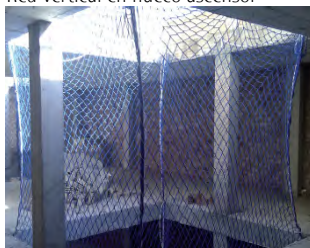
Red vertical en hueco ascensor
