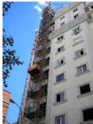
Montacargas en fachada
