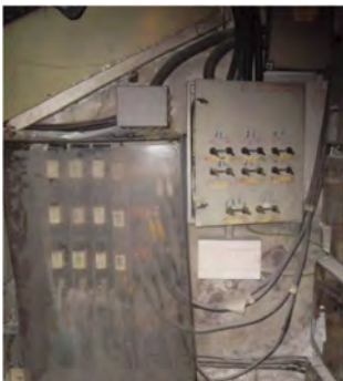
Instalación antigua de acometida de BT con partes accesible
