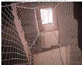
Red vertical en hueco escalera
