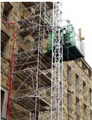
Montacargas en fachada
