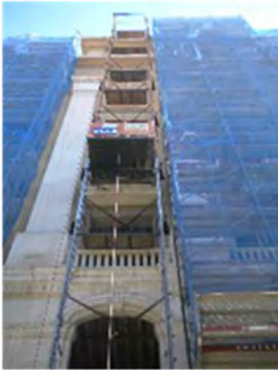
Montacargas en fachada
