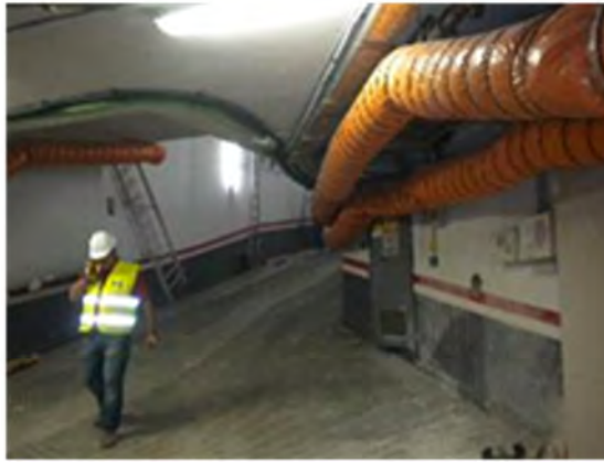
Boca de Tubería de extracción en sótano
