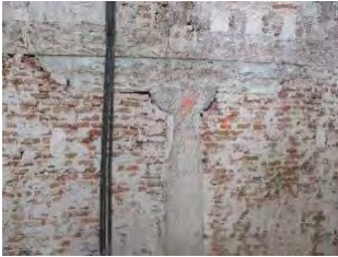
Capitel de madera tras haberse realizado la inspección de daños y la cala de la superficie a evaluar.
