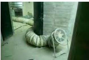
Ramal de ventilación de humos
