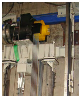
Variador de frecuencia ascensores
