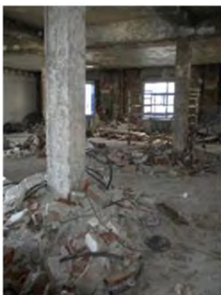
Acopio de material de escombros junto a pilares.
