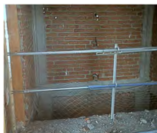
Red horizontal en hueco ascensor
