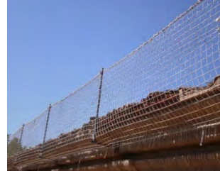
Sistema de protección con red vertical en perímetro de cubierta.
