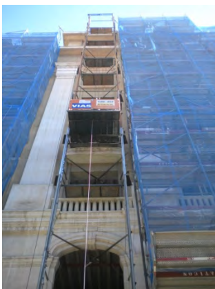
Montacargas en fachada
