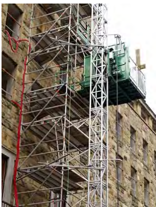
Montacargas en fachada
