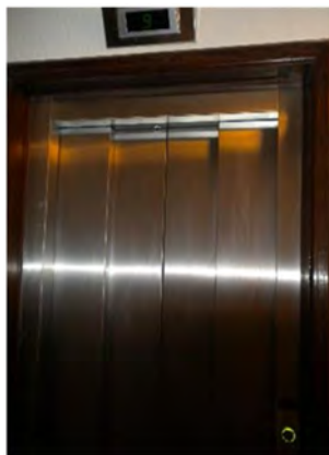
Puerta de ascensor en planta
