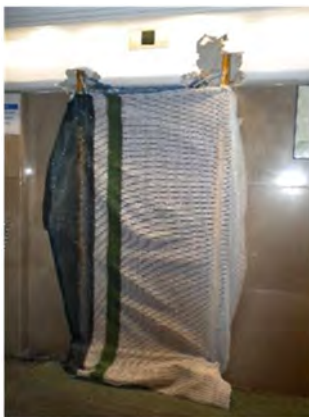
Protección vertical en hueco
