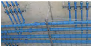
SopORTE tuberías mediante bandejas
