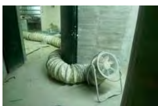
Ramal de ventilación de humos
