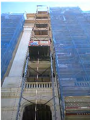
Montacargas en fachada
