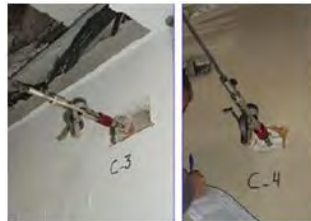
Cintas de convergencia y varillas
