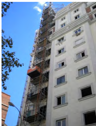
Montacargas en fachada
