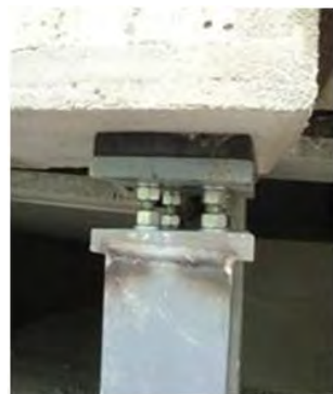
Sistema de entrada en carga con apriete de tornillería sosteniendo estructura de hormigón
