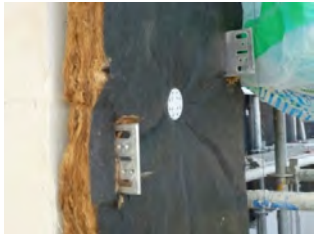
Aislamiento de lana de roca
