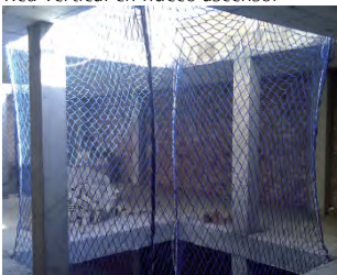
Red vertical en hueco ascensor
