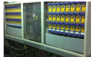
Instalación modificada, sin partes accesibles
