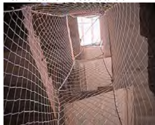
Red vertical en hueco escalera
