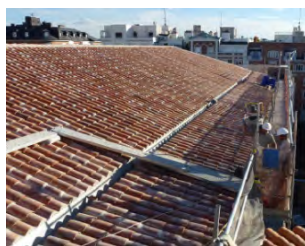
Pasarelas de acceso/paso en cubiertas
