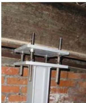
Sistema de entrada en carga con apriete de tornillería sosteniendo estructura metálica
