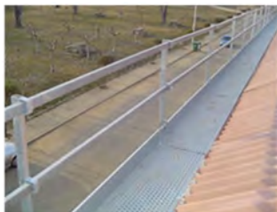
Protección colectiva mediante pasarela y sistema provisional de protección de borde
