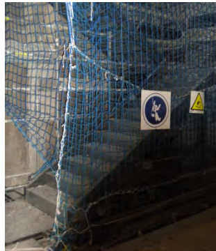
Red vertical en hueco escalera
