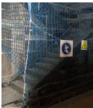
Red vertical en hueco escalera
