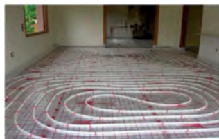
Instalación térmica: suelo radiante
