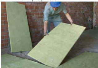
Lana de roca en suelo
