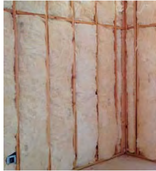
Aislamiento con fibra de vidrio
