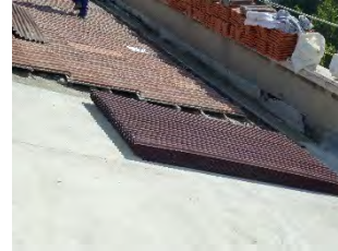
Placa bituminosa ondulada
