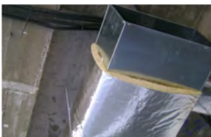
Conducto de chapa metálica
