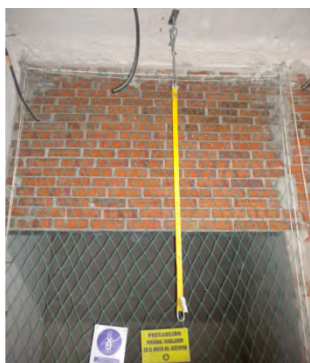
Red vertical en hueco ascensor
