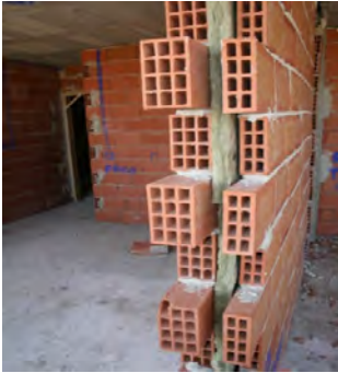
Aislamiento lana de roca
