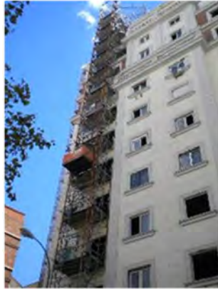
Montacargas en fachada
