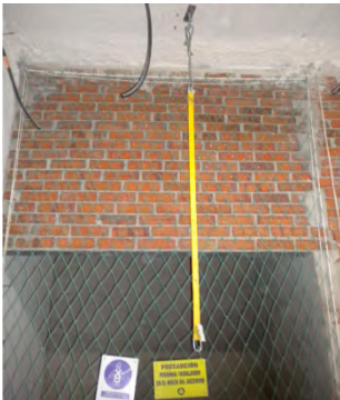
Red vertical en hueco ascensor
