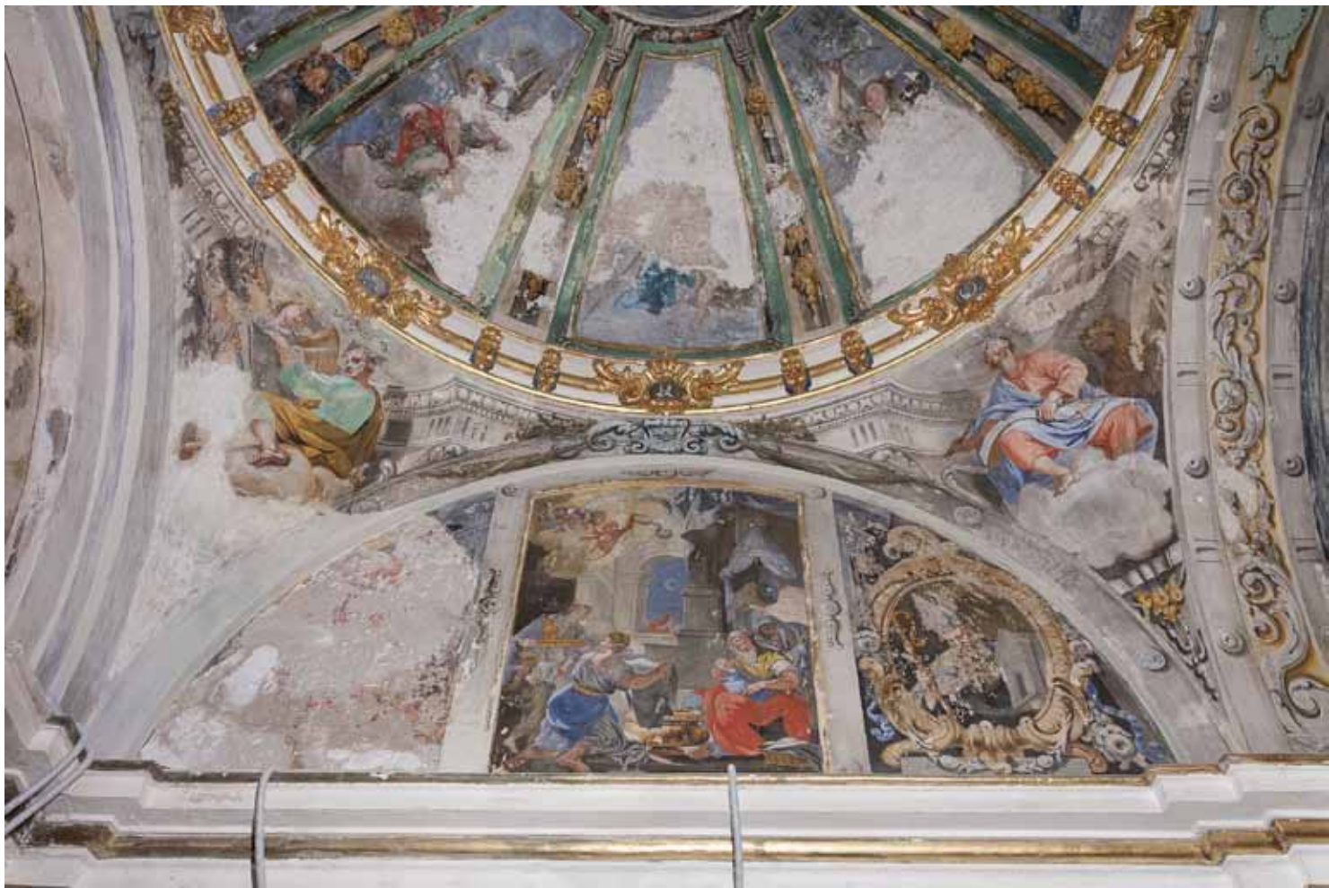
3. Daños de la humedad producidos en el año 1999 en cúpula, pechina y luneto. Foto VM
