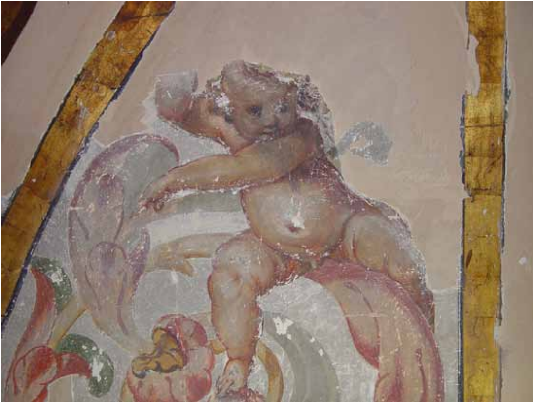
5. La superposición de capas de pintura para adecuar al nuevo gusto o utilidad del edificio es corriente en los paramentos murales. Foto GFG
