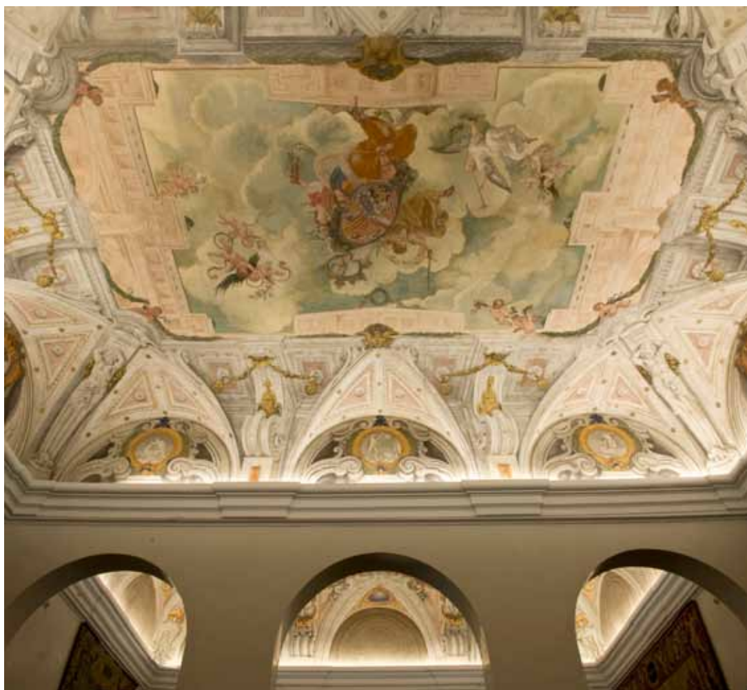
29. Casa de la Panadería. Cuarto Real (Madrid). Vista General de la bóveda. Claudio Coello y José Jiménez Donoso. Foto JCML
