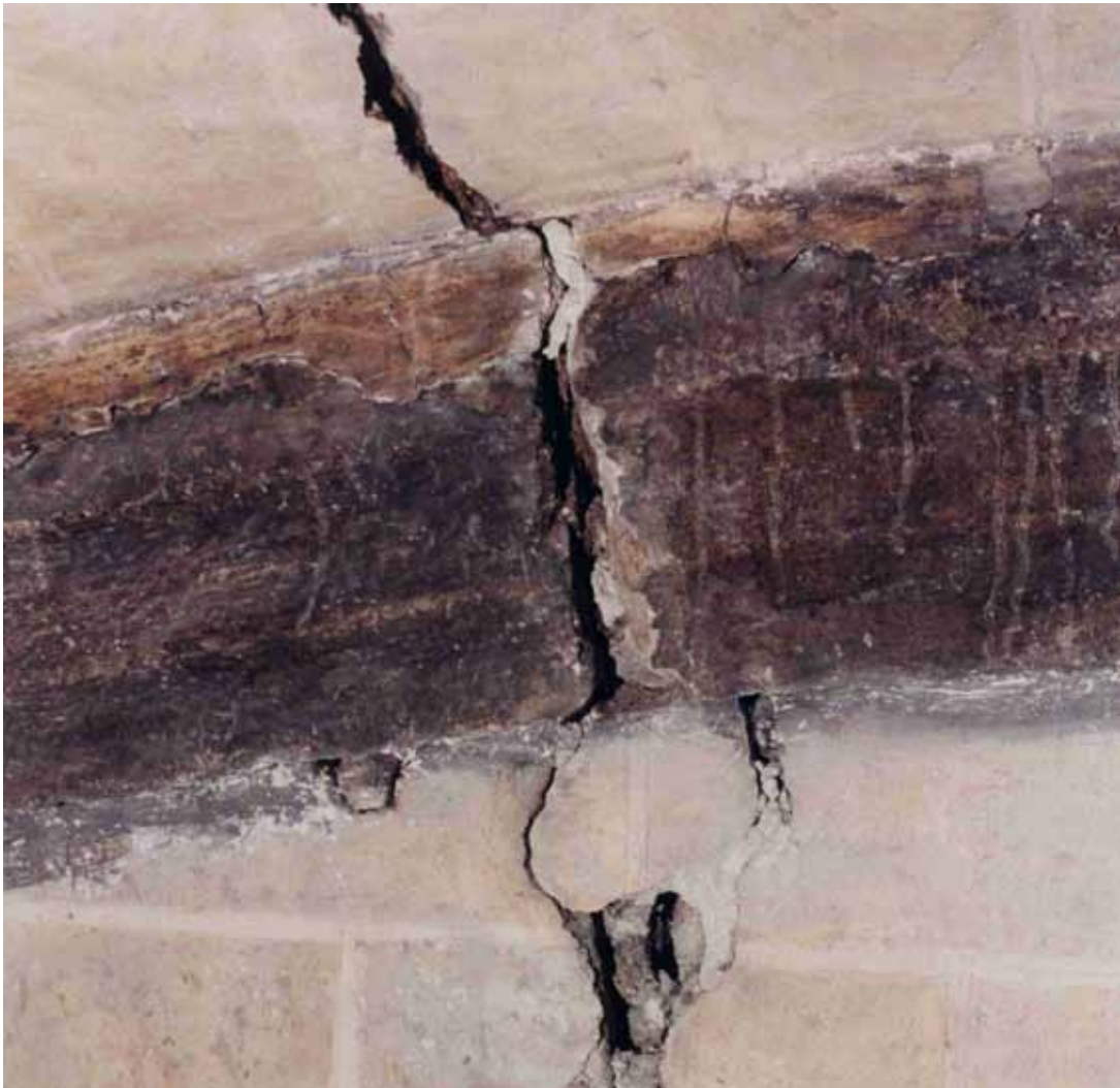
3. Grietas de la zona del coro, se puede apreciar cómo han desplazado el soporte. Foto Ágora S.L.
