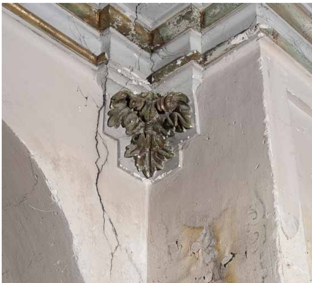
2. Unico fragmento de pintura que se veía en los paramentos antes de la intervención. Foto AB
