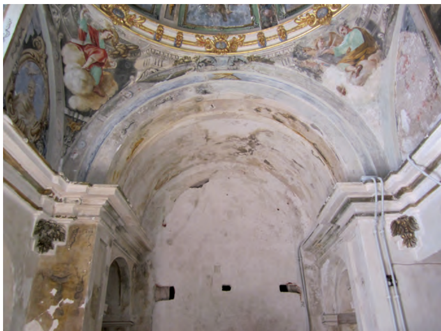
Estado del camarín antes de la restauración.
