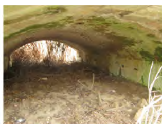
3. El interior se encuentra construido con bóvedas de ladrillo de cañón o escaranzas con embocaduras de sillería que apoyan sobre pilas de sillería aplanillada con tajamares semicilíndricos adosados en ambos paramentos y rematados por sombreretes semicónicos.
