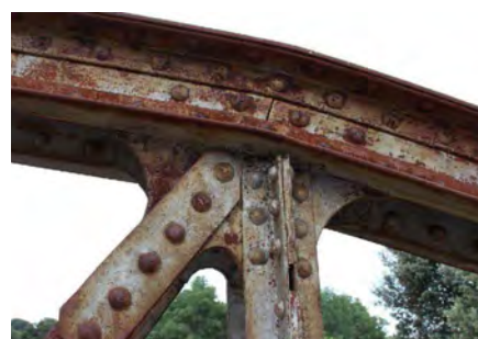
Estado de los elementos metálicos del puente, donde se observa en la foto uno de los nudos superiores de la parábola. Uniones roblonadas.
