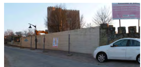
Muro a sustituir en el proyecto. Se aprecia como la materialidad es completamente opuesta a los materiales tradicionales utilizados en el castillo, siendo más propio de un recinto industrial, por lo que desentonan enormemente e influyen negativamente en la imagen de este importante bien patrimonial.
