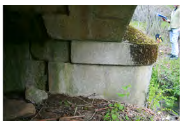
2. Detalle lateral de uno de los tajamares. La impostilla que zuncha las pilas y los estribos al nivel del arranque de estas, diferencia el límite en el interior entre los sillares y el arranque del ladrillo.
