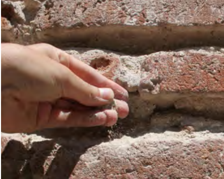
Proceso de arenización de los morteros que deja los ladrillos sin junta
