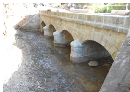
Vista general del puente, después de la intervención, donde podemos apreciar la estructura y la regularidad de sus elementos.
