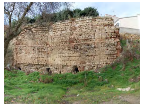
Zona A.3. Lienzo "de las Cuevas", junto al arroyo Valdejudíos. Estado previo a la actuación.
