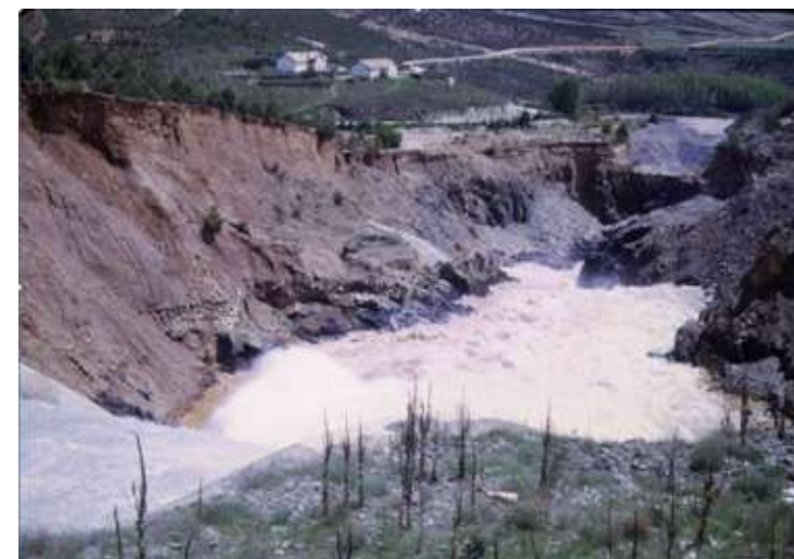
Figura 4.173. Aliviadero lateral vertiendo agua, con las erosiones ocasionadas. Al fondo, los albergues para obreros que construyeron la presa de El Vado. Ca 1974
