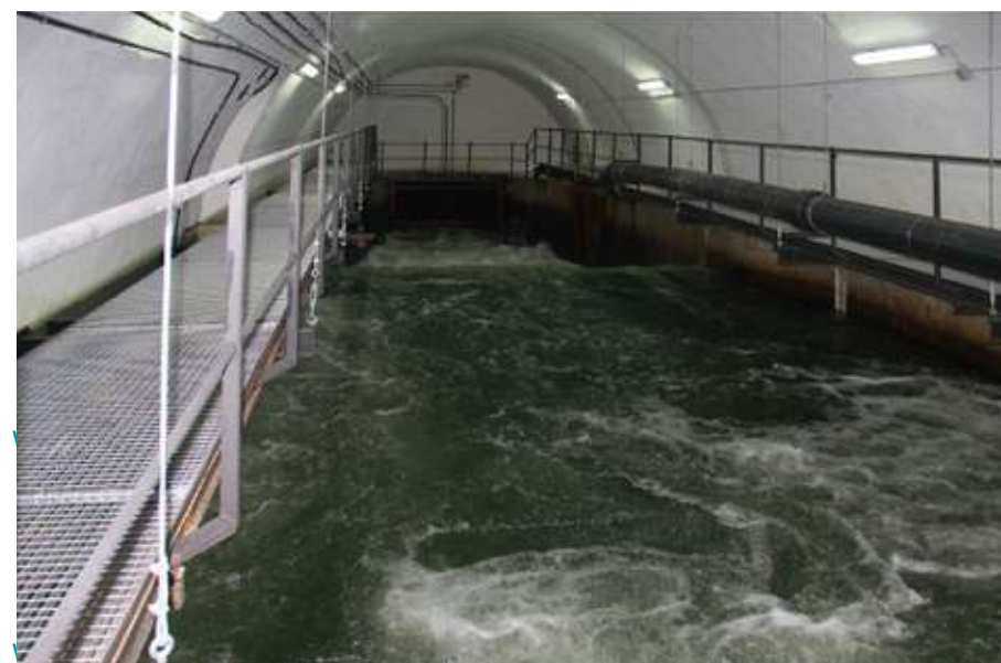
Figura 5.44. Agua entrando en el canal del Jarama desde la cámara de rotura de carga
