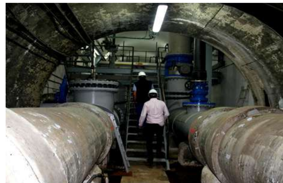
Figura 5.43. Acceso a la plataforma sobre las válvulas y cámara de rotura de carga
