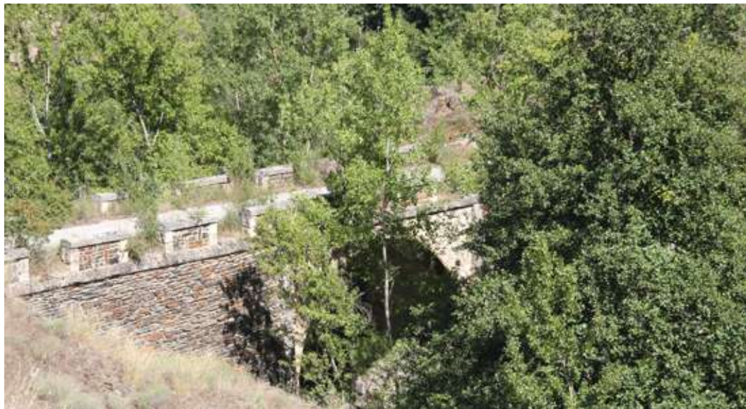
Figura 5.23. Vista del puente sobre el barranco del Corcovado desde el acceso a la estación de aforos, oculto por la vegetación
