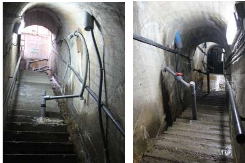
Figuras 6.15 y 6.16 Interior de la galería perimetral de la presa del Pozo de Los Ramos, donde se observan los drenes
