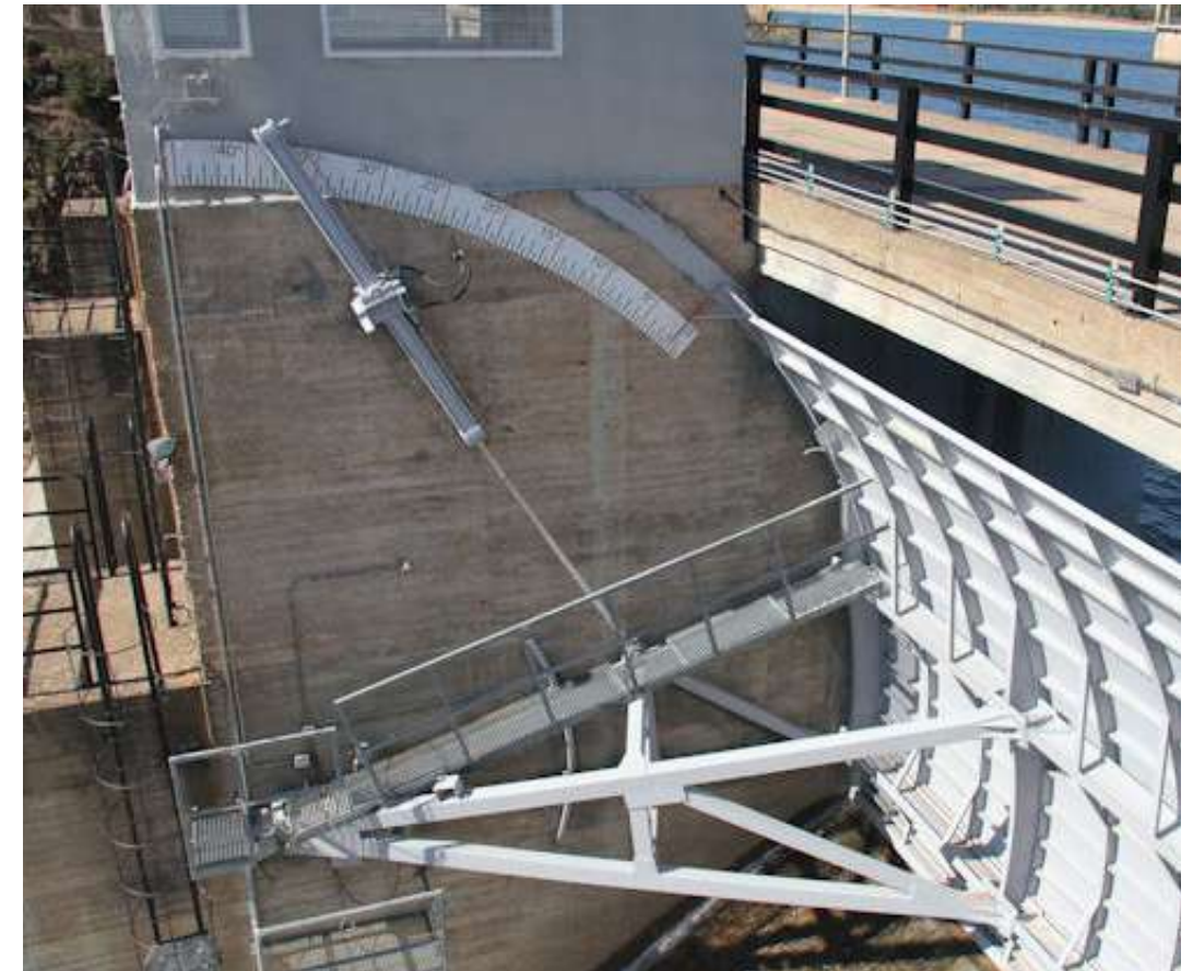
Figura 4.170. El Vado. Detalle de una compuerta Taintor en la presa principal
