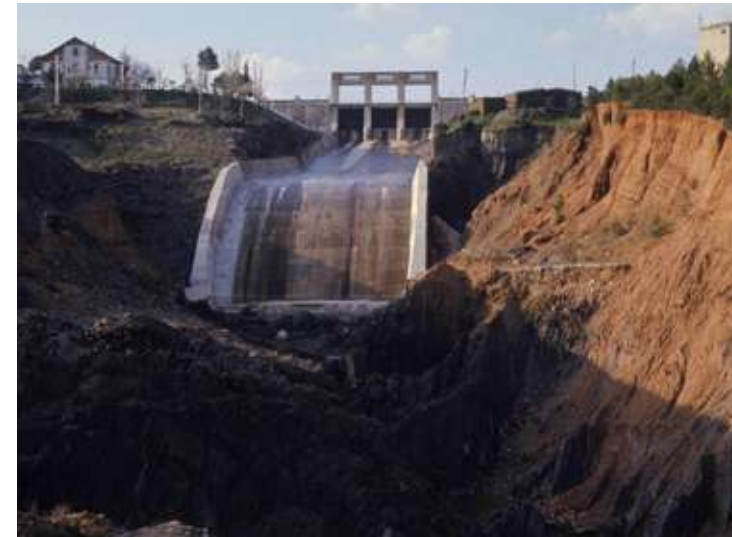
Figura 4.172. Aliviadero lateral. Efectos erosivos de los vertidos al final del canal revestido. Ca 1974
