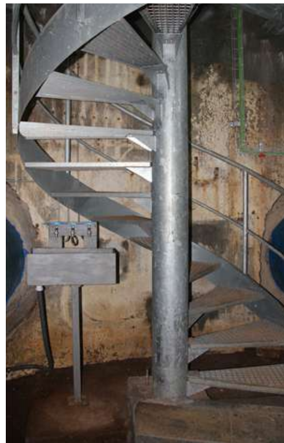
Figura 5.41. Interior en la base de la torre, con el arranque de la escalera de acceso a las tomas, y pila para recoger muestras de agua
