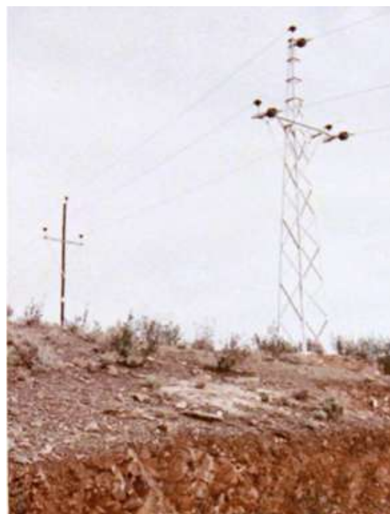
Figura 5.28. Castilletes metálicos y poste de madera en la línea de alta tensión
