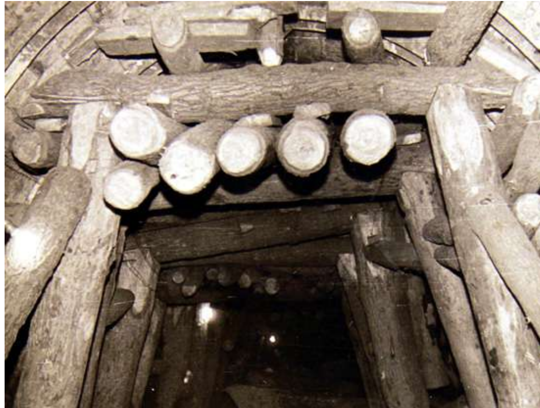
Figura 5.47. Entibaciones en la perforación de un túnel en zona de fuerte empuje
