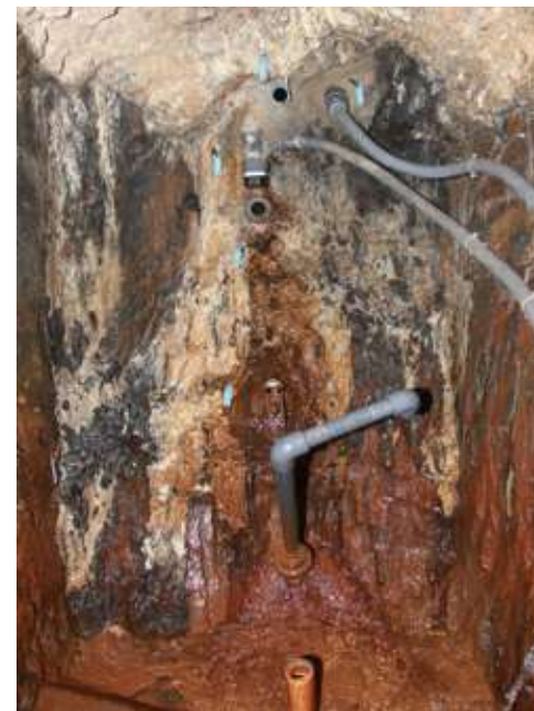
Figura 4.181 Conducciones de drenes en la galería intermedia de la presa de El Vado
