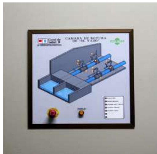
Figura 5.45. Panel de control y monitorización del sistema de maniobra
