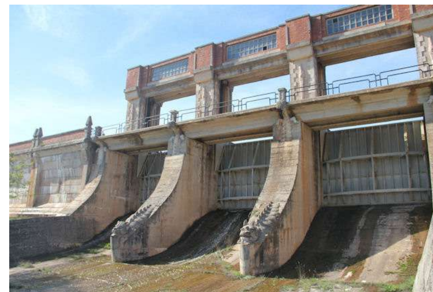
Figura 4.80. El Vado. Aliviadero del dique del Collado, vertedero con compuertas, desde aguas abajo
