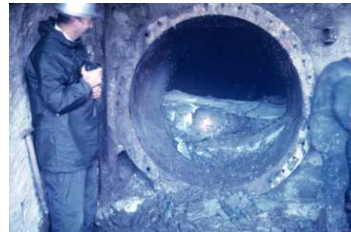
Figura 4.157. El Vado, desagües intermedios. Acumulación de lodos descubierta al abrirlos para para sustitución de válvulas. Ca. 1971-72
