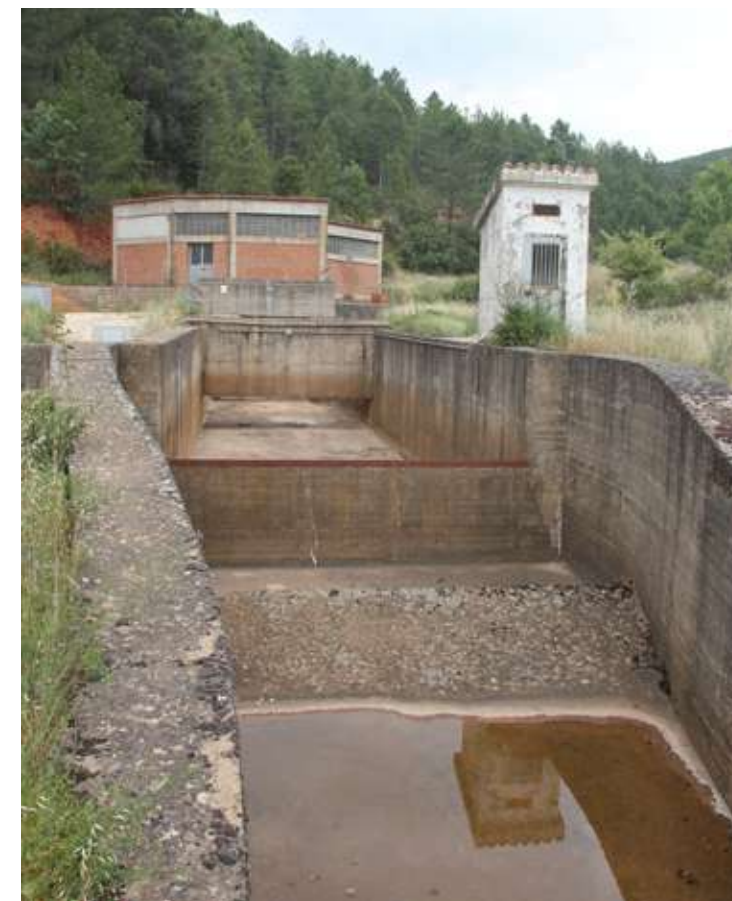
Figura 6.28. Almenara del trasvase Sorbe-Jarama junto al arroyo de la Virgen, con vertedero de aforos
