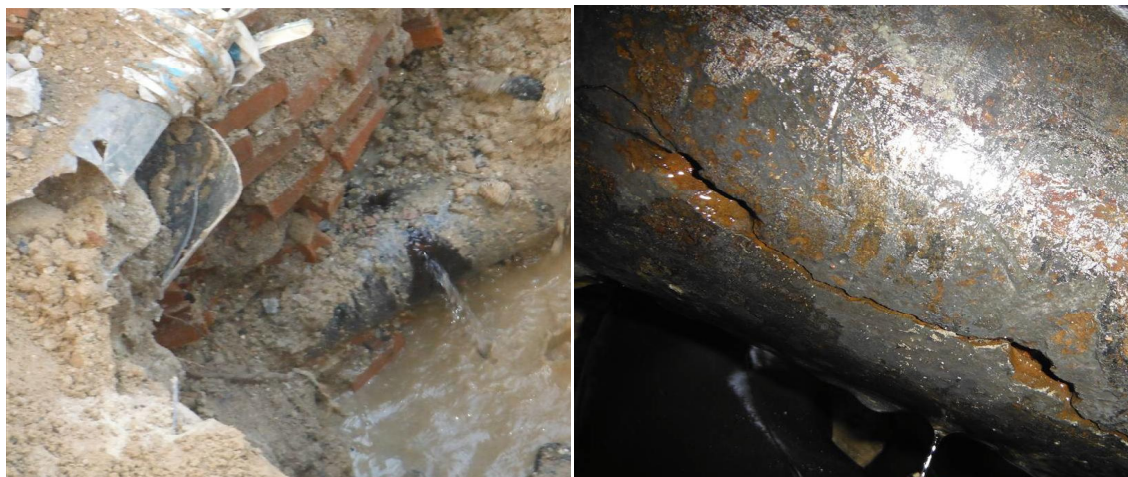
FIGURA 61. ROTURAS EN TUBERÍAS DE FUNDICIÓN GRIS
