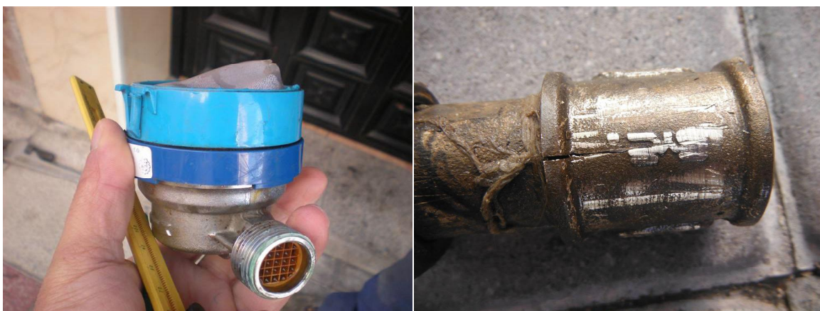
Rotura de parte plástica de contador por efecto de la congelación
