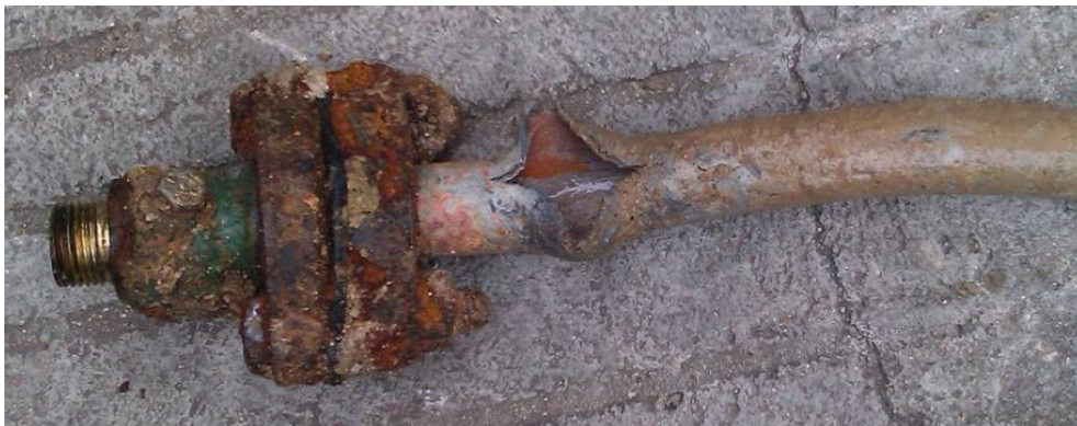
FIGURA 133. ACOMETIDA DE PLOMO CON ROTURA LONGITUDINAL POR DEFECTO DE MATERIAL
