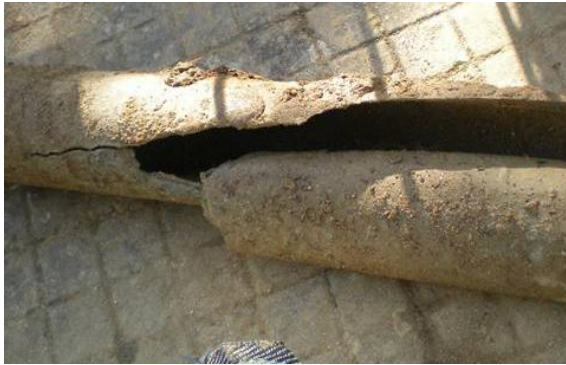
Rotura explosiva en tubo de fibrocemento
