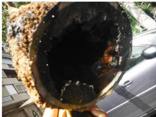
Tubo de fundición con múltiples incrustaciones
