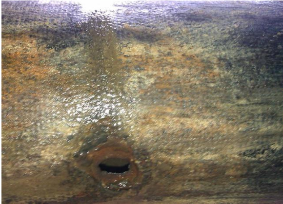
Agujero en tubería de fundición dúctil
