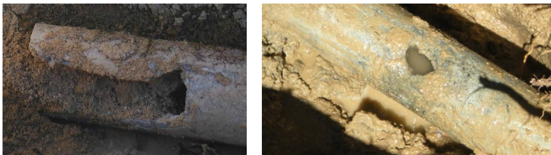
FIGURA 117. TUBERÍAS DE FIBROCEMENTO CON ROTURA EXPLOSIVA POR VARIACIONES DE PRESIÓN
