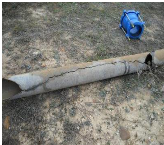
Tubería de fibrocemento con fallo longitudinal
