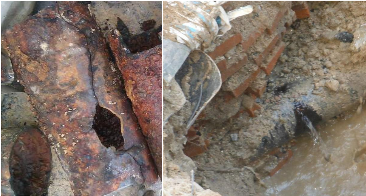
FIGURA 111. ROTURAS EN TUBERÍA DE FUNDICIÓN GRIS, POR CORROSIÓN Y SOBRECARGA
