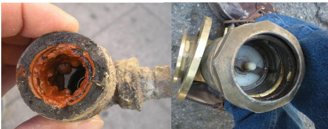
Válvula de compuerta con obturador de fundición gris, afectada por incrustaciones de hierro y de tipo calcáreo
