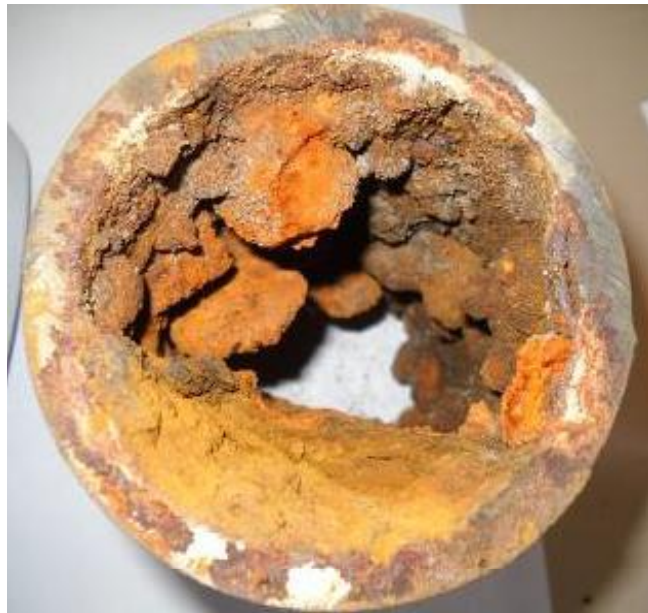
FIGURA 112. TUBO DE FUNDICIÓN GRIS SEMIOBSTRUÍDO POR INCRUSTACIONES
