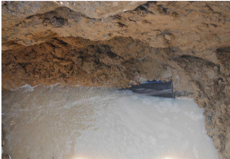
Fuga en unión electrosoldada en una tubería de polietileno
