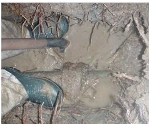
Presencia de grandes raíces que provocaron una fisura en tubería de fibrocemento
