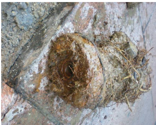
Raíces que provocaron fugas al penetrar en las juntas y uniones
