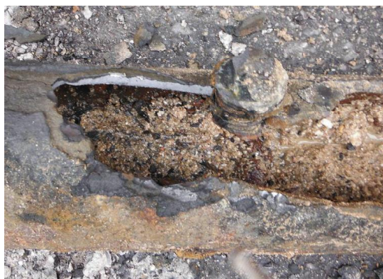
Agujero de corrosión externa en una tubería de fundición gris; se observa la reducción del espesor del metal original en los bordes de la fisura
