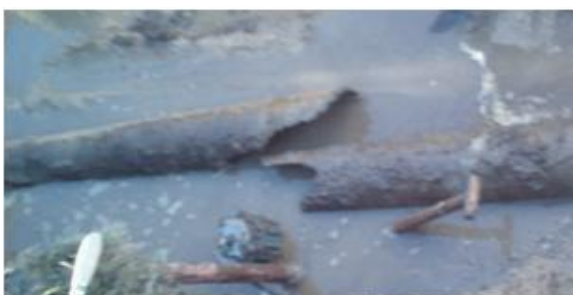
Rotura provocada por retroexcavadora en tubería de fibrocemento
