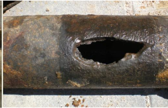
Rotura explosiva en tubo de fundición gris
