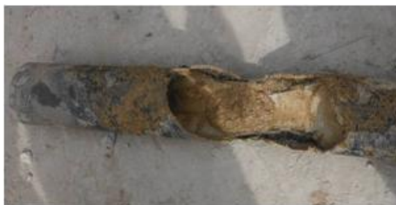
Rotura provocada durante la ejecución de una hinca para alcantarillado en tubería de fundición dúctil
