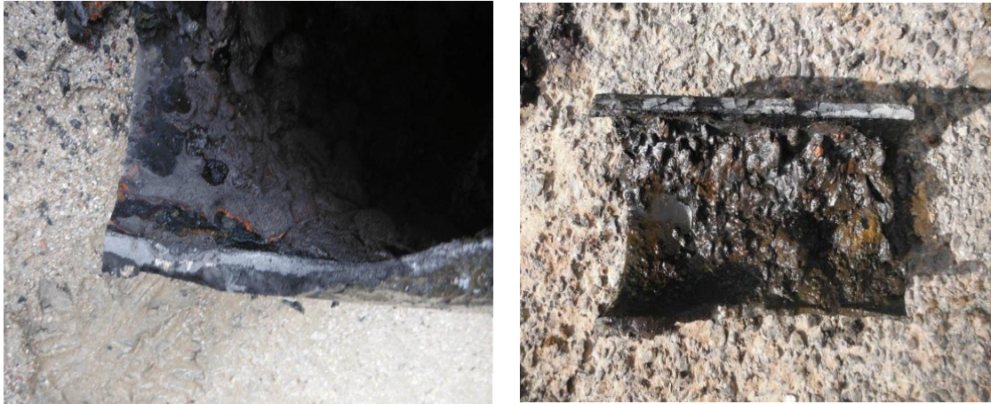
FIGURA 59. PRESENCIA DE ÓXIDO NEGRO EN TUBERÍAS DE FUNDICIÓN GRIS
