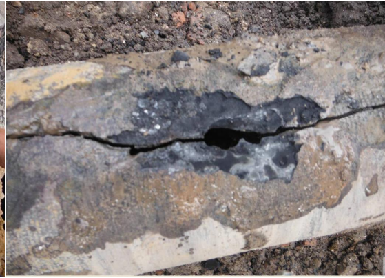
Rotura longitudinal en tubo de PVC
