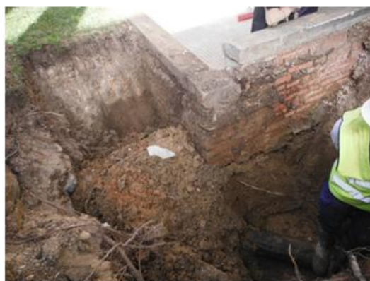
El muro provocó una fisura circunferencial en la tubería de fundición gris
