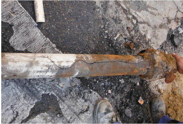
Rotura longitudinal en tubo de plomo
