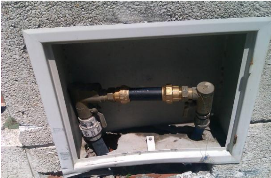
FIGURA 71. ROBO DE CONTADOR, SE COLOCÓ UN PUENTE DE POLIETILENO PROVISIONAL
