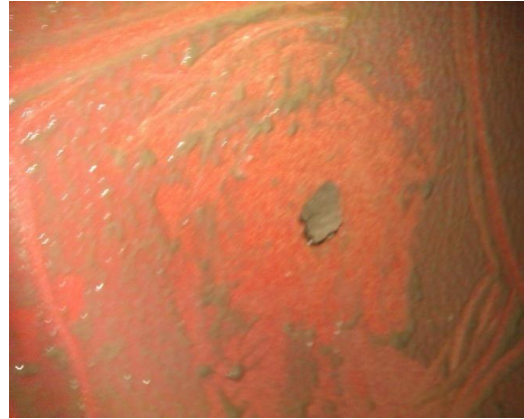
Agujero en tubería de acero
