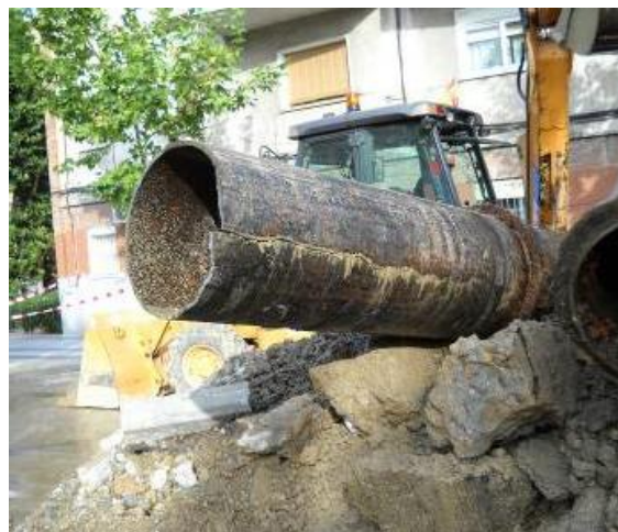
Tubería de fundición gris con fallo longitudinal
