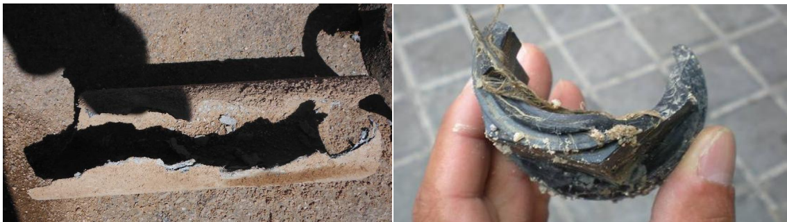
Rotura en pared de tubo
