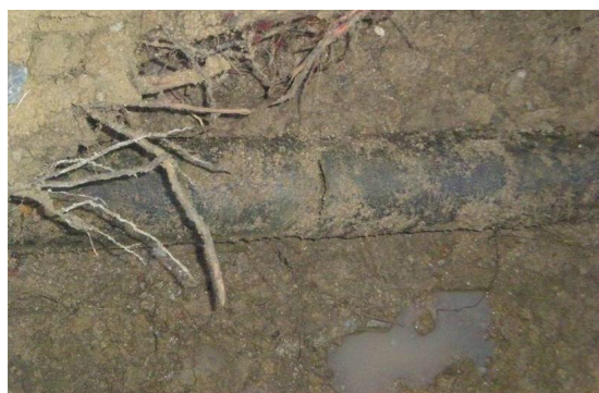
Rotura circunferencial en tubo de fundición gris
