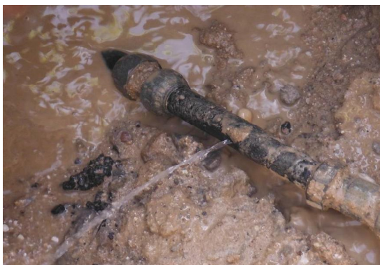
Poro en pared de tubo de polietileno
