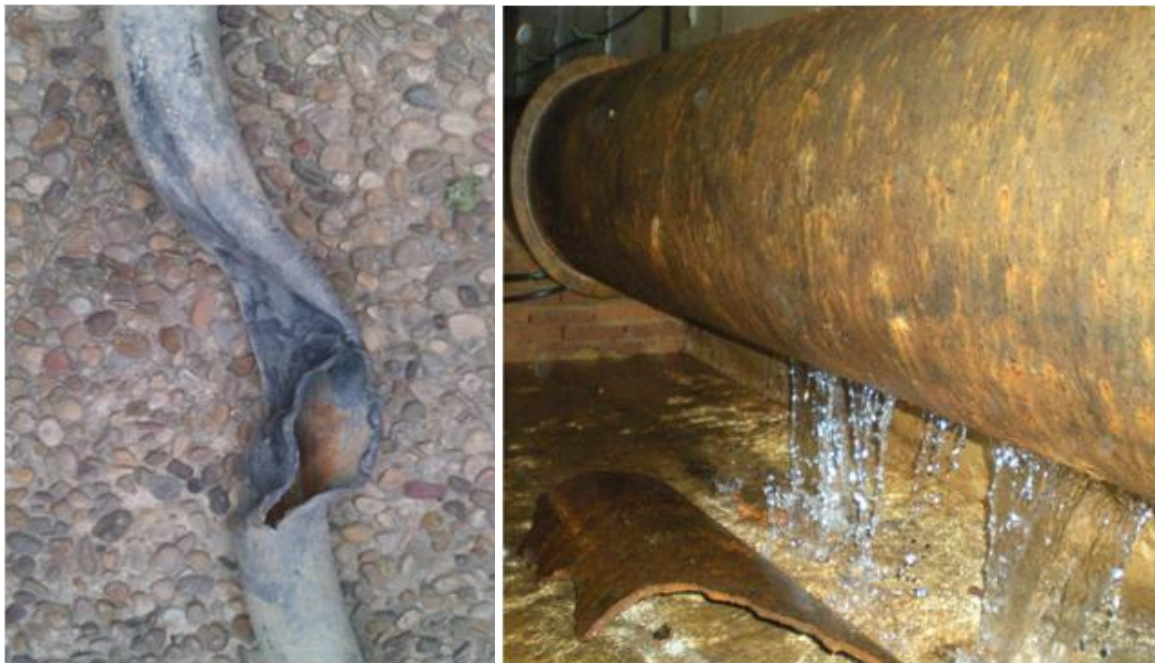
FIGURA 60. ROTURAS EN TUBERÍA PLOMO Y FUNDICIÓN GRIS
