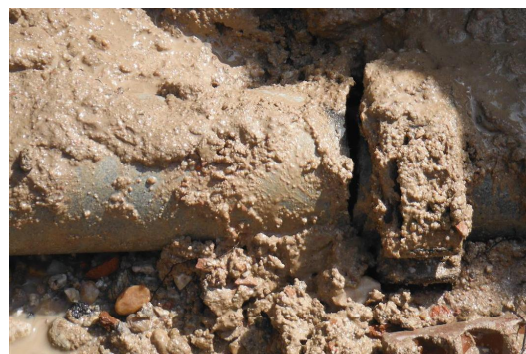
Rotura circunferencial en tubo de fibrocemento, junto a una brida
