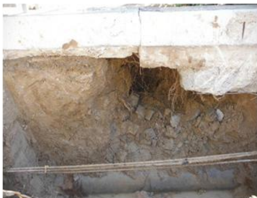
La carga del muro creó una fisura circunferencial en la tubería de fibrocemento situada debajo
