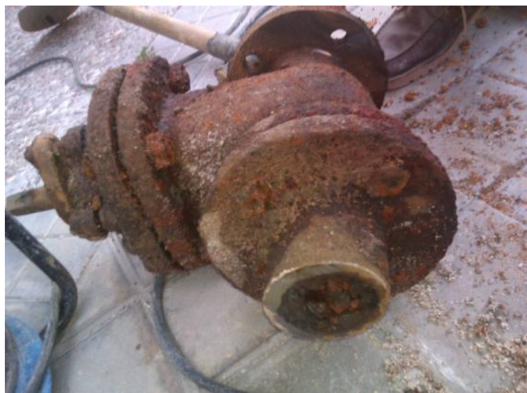
FIGURA 72. PÉRDIDA DE FUNCIONALIDAD EN UNA VÁLVULA DE COMPUERTA, POR CORROSIÓN E INCRUSTACIONES DE HIERRO
