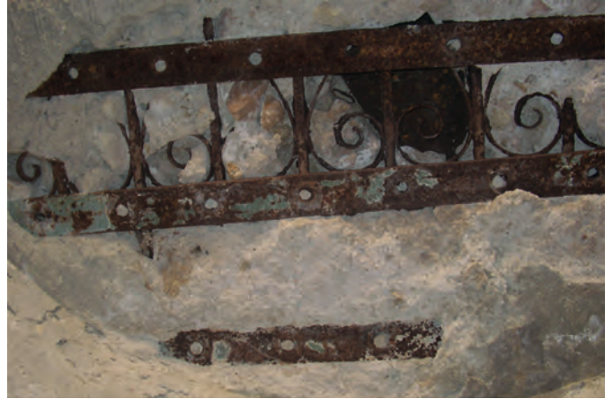
Fig. 50 La penuria de materiales llevaba en ocasiones a sustituir la ferralla por chatarra en la armadura del hormigón, como en el techo de este nido de Valdemorillo (Pablo Schnell Quiertant).
