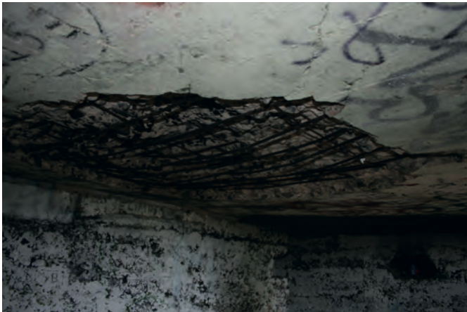
Fig. 51 El revoco del techo ha caído y la armadura interior del techo de hormigón ha quedado a la vista en esta obra de Paracuellos del Jarama (Pablo Schnell Quiertant).
