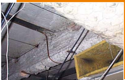
Amianto en estructura. Fotografía: Paulino Pastor
