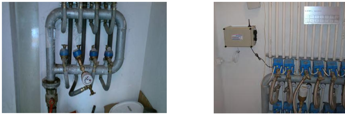
FIGURA 83. CONTADOR PARA EL CONTROL DE CONSUMO DE AGUA EN EL DOMICILIO (IZQUIERDA). ESTACIÓN REMOTA PARA REGISTRO Y TRANSMISIÓN DE DATOS (DERECHA DE LA FIGURA)
