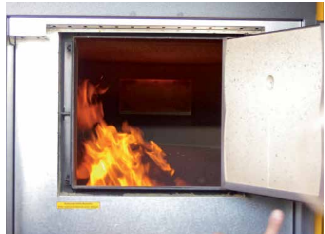
Caldera de biomasa
