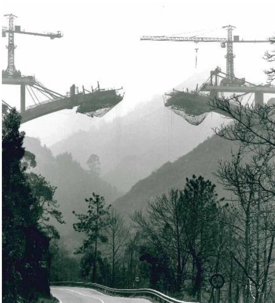
Fondo Fotográfico Ana Muller. Obras de construcción del puente Arco de La Regenta, en el tramo Novellana-Cadavedo (Asturias) de la carretera N-634, situado sobre el valle del río Cabo (1994-1997).
