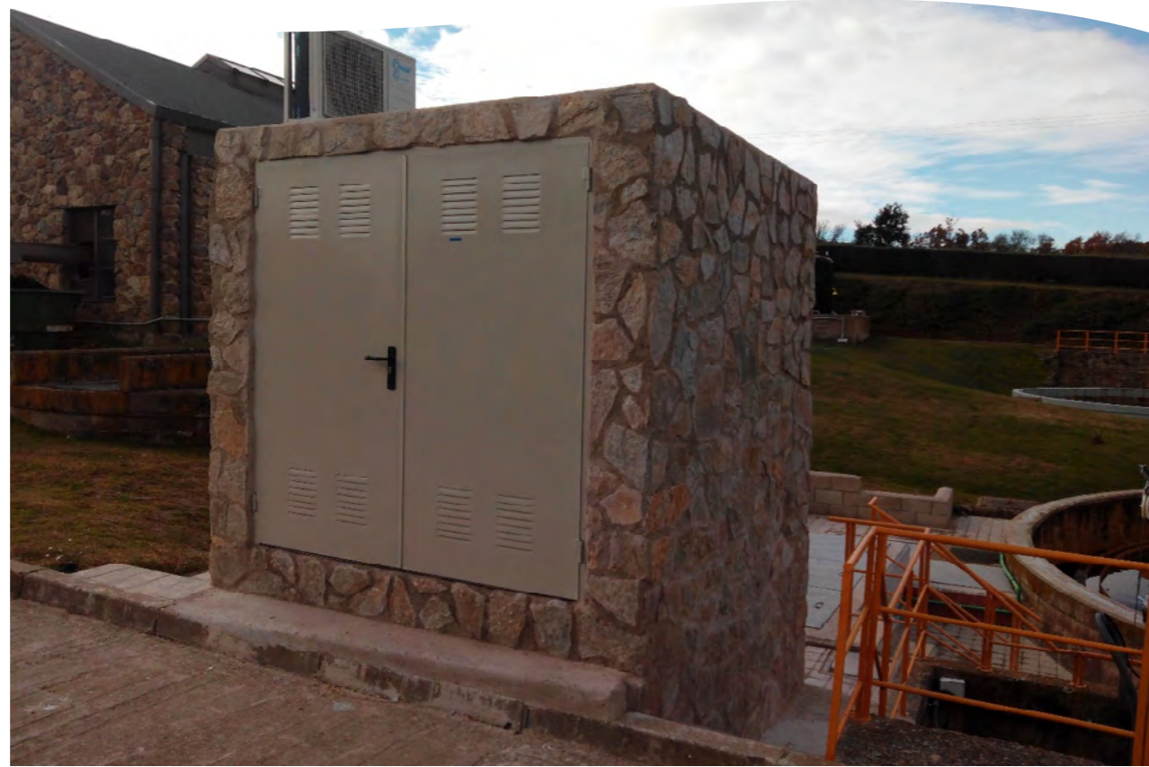
Figura 7: Caseta prefabricada EDAR Riosequillo.
