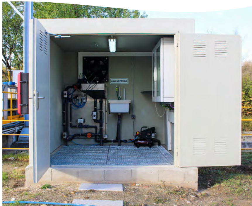
Figura 3: Estación de medida de la EDAR El Vellón.
