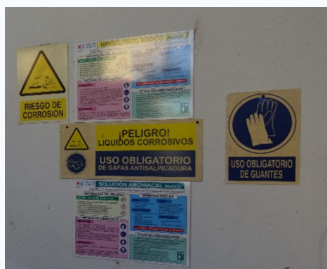
Señales de advertencia y obligación en sala de dosificación
