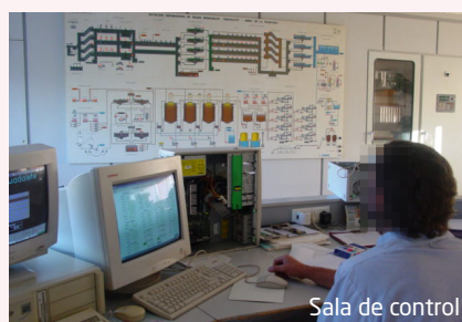
Tareas de control de paneles
