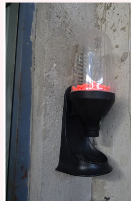
Protectores auditivos a la entrada de sala de bombas
