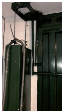
Contrapeso sin protección
