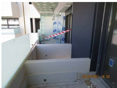
Figura 1: Lateral de la terraza sin protección
