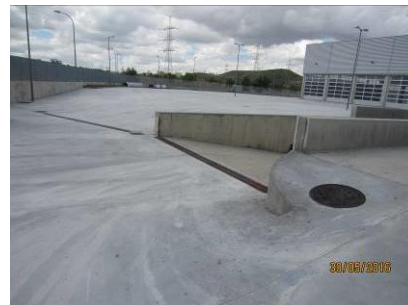
Figura 3: Vista de la rampa donde acontece el accidente
