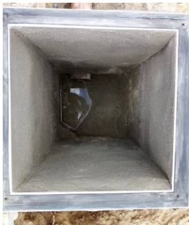
Figura 1. Arqueta sin protección ni señalización.
