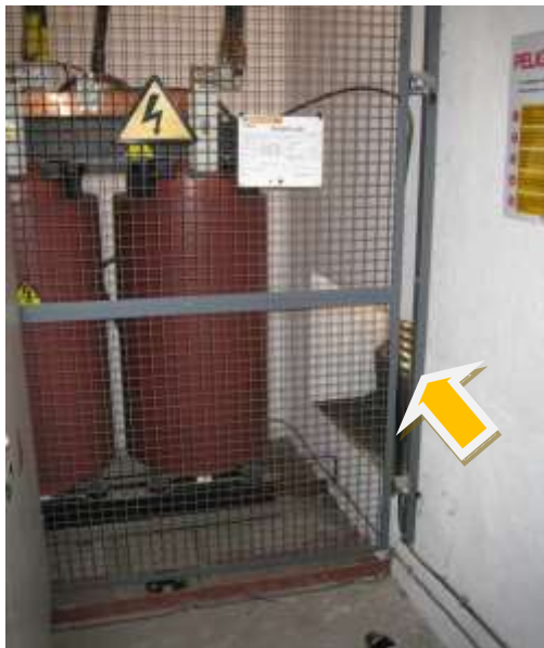
Foto 1.- Rejilla situada en el muro del local.
