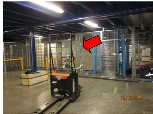
Foto 2.- Línea de pallets paralizada por el bloqueo de la plataforma elevadora.
