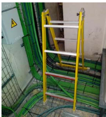
Figuras 1: Ubicación de la escalera de mano sobre bandeja metálica
