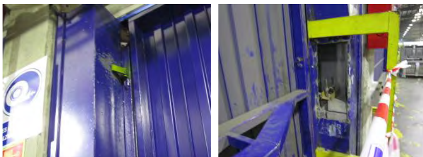
Figuras 1 y 2: Detalle del portón implicado en el accidente.
