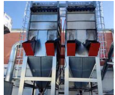
Figura 3: Estado de los filtros de aspiración.
